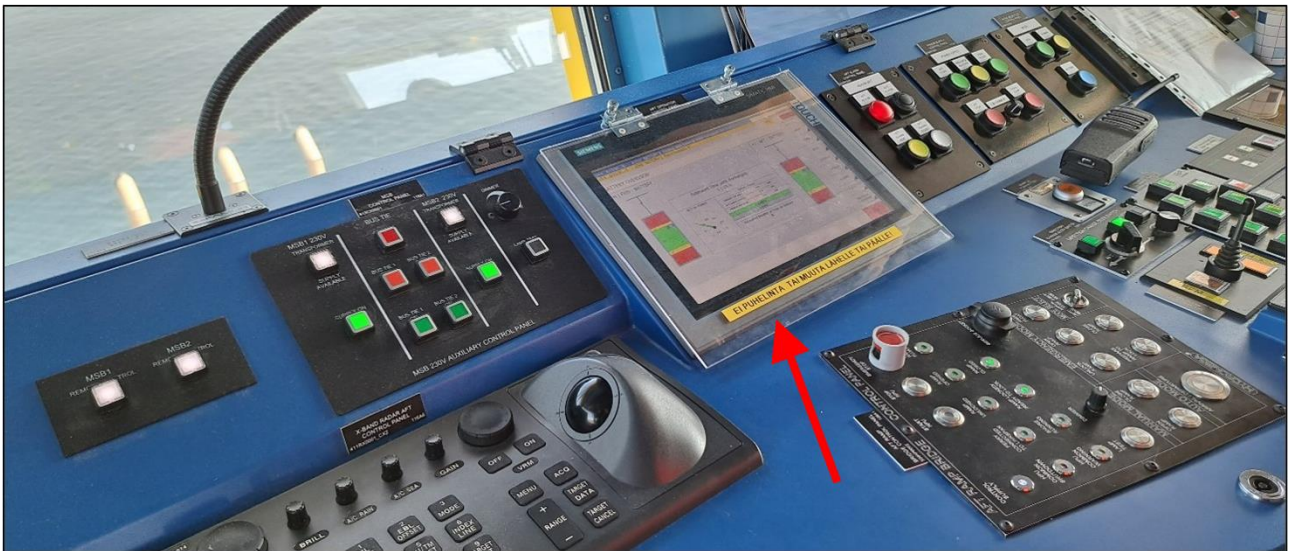
Kuva 12. Siemensin sähkökäyttöjen kosketusnäytön sijainti (nuoli). Näytön päälle on asennettu onnettomuuden jälkeen suoja muovilevystä. (Kuva: OTKES)
