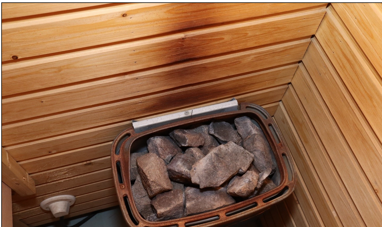
Kuva 15. Onnettomuuskiinteistön toisen asunnon saunan kiuas. Paneeliseinä kiukaan päältä oli merkittävästi tummunut. Osa kiukaan päällimmäisistä kivistä oli varsin isoja. (Kuva: OTKES)
