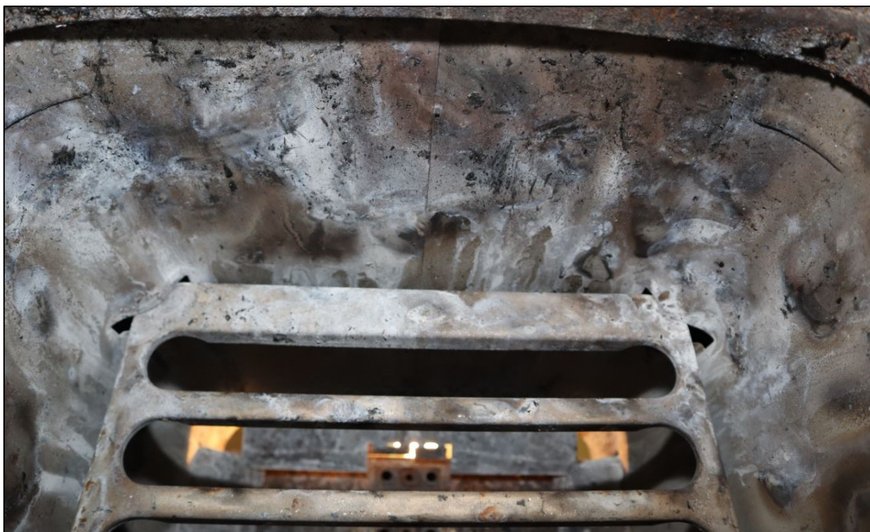
Kuva 12. Kiukaan kivitalan vaipassa oli kauttaaltaan erikokoisia pullistumia. Kuvaushetkellä vastukset eivät olleet paikallaan.
