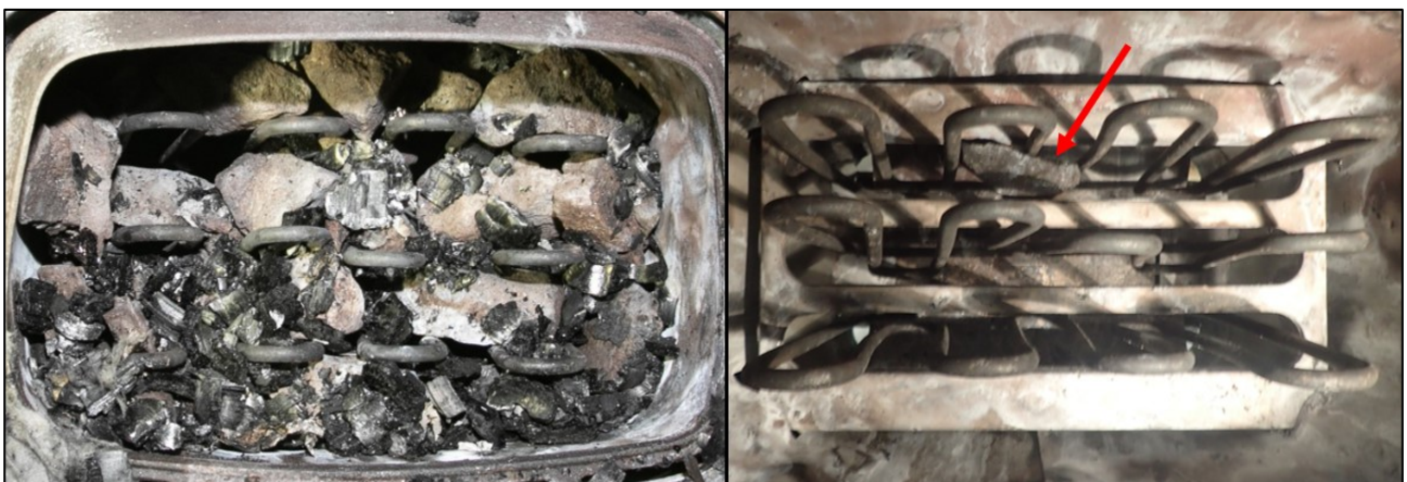
Kuva 18. Vasemmalla paikkatutkinnan aikana otettu kuva, jolloin kiukaasta oli jo poistettu noin kaksi kerrosta kiviä. Kivet olivat tiiviisti kiinni sekä toisissaan että sähkövastuksissa ja kivitilan vaipassa. Hiiltyneet puupalat ovat pudonneet kiukaan päälle tulipalo aikana. Oikealla kiven poiston jälkeen otetussa kuvassa näkyy yksi tiukkaan kiilautunut kivi, joka oli painanut vastuksen kiinni kiukaan metallirakenteeseen. (Vasen kuva: poliisi; oikea kuva: OTKES)
