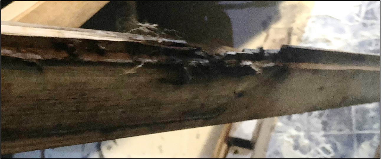
Kuva 20. Päijät-Hämeen tulipalossa kiukaan takana ollut paneeli hiilti merkittävästi. (Kuva: Päijät-Hämeen pelastuslaitos)
