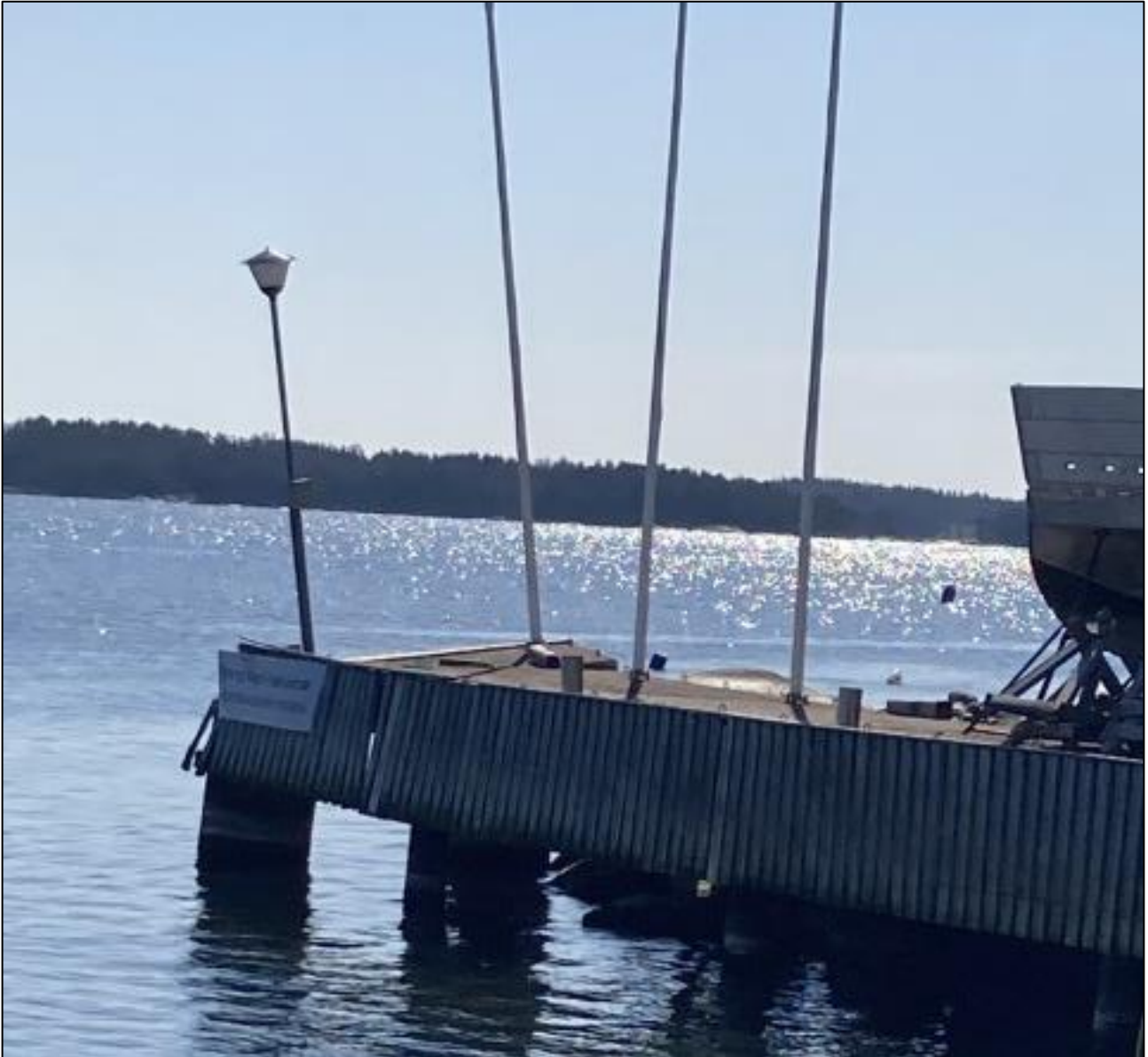
Kuva 3. Lossin törmäys väänsi venesataman laiturirakenteita. (Kuva: OTKES)
