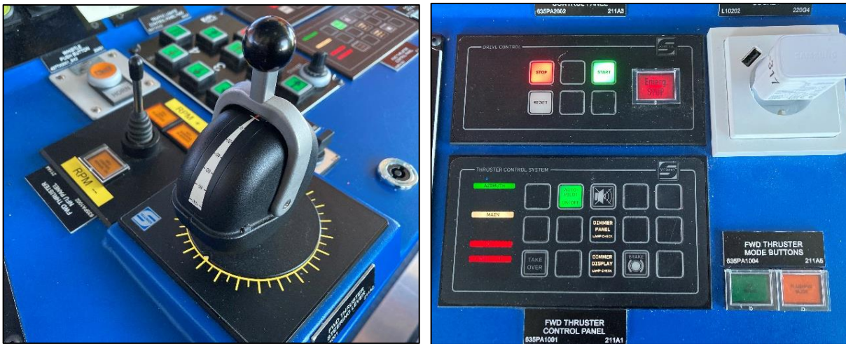
Kuva 14. Vasemmanpuoleisessa kuvassa lossi L-317:n rakenteellisen keulapotkurin ohjailukahva sekä varaohjausvipu. Oikeanpuoleisessa rakenteellisen keulapotkurin ohjauspaneelit. (Kuvat: OTKES)
