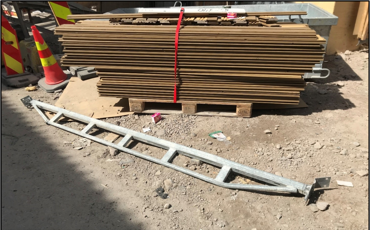
Kuva 5. Poikittaispalkki ja kiinnitysosat, joista oikeanpuolimmainen on taipunut kokonaan auki. (Kuva: OTKES)
