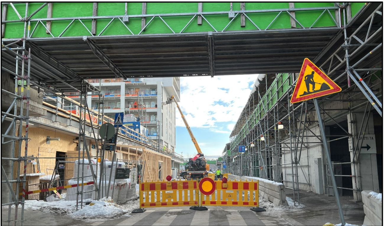
Kuva 3. Sortunut silta ennen onnettomuutta maaliskuussa 2023. Sillan kannen alla näkyy kaksi poikittaispalkkia, jotka olivat kiinnitysosien avulla pitkittäispalkkien alapaarteiden varassa. (Kuva: ulkopuolinen kuvaaja)
