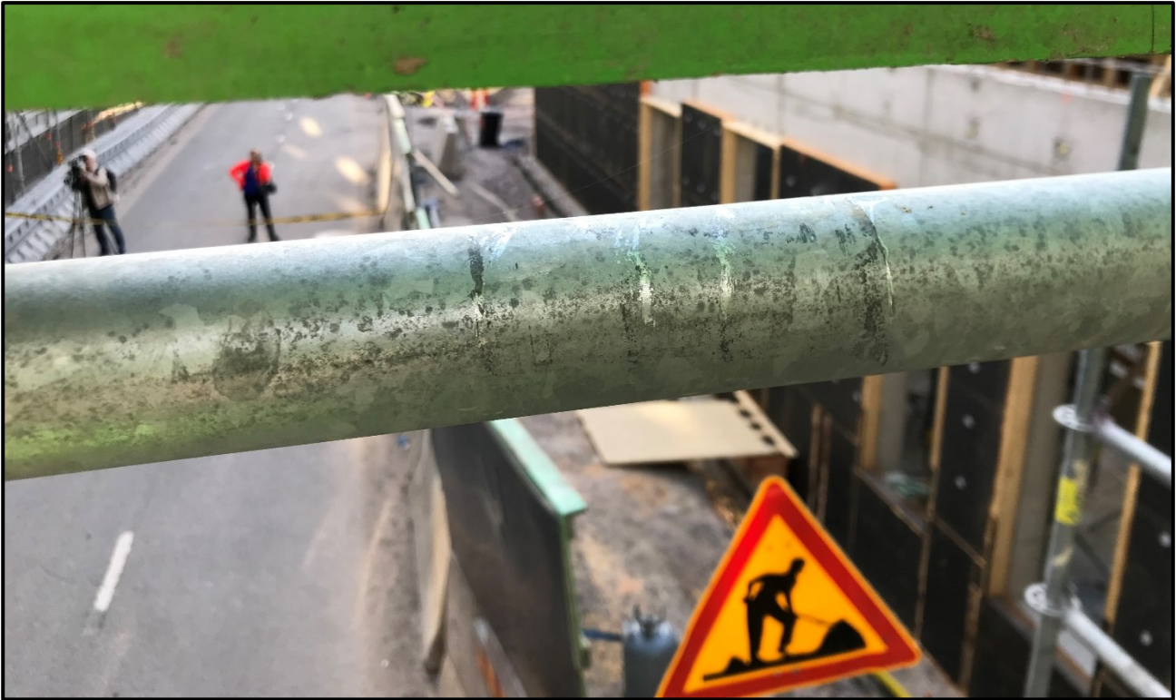
Kuva 6. Pitkittäispalkin alapaarre, jonka varassa poikittaispalkit olivat kiinnitysosien avulla. Jäljet alapaarteessa ovat auki taipuneiden kiinnitysosien jättämät. (Kuva: OTKES)
