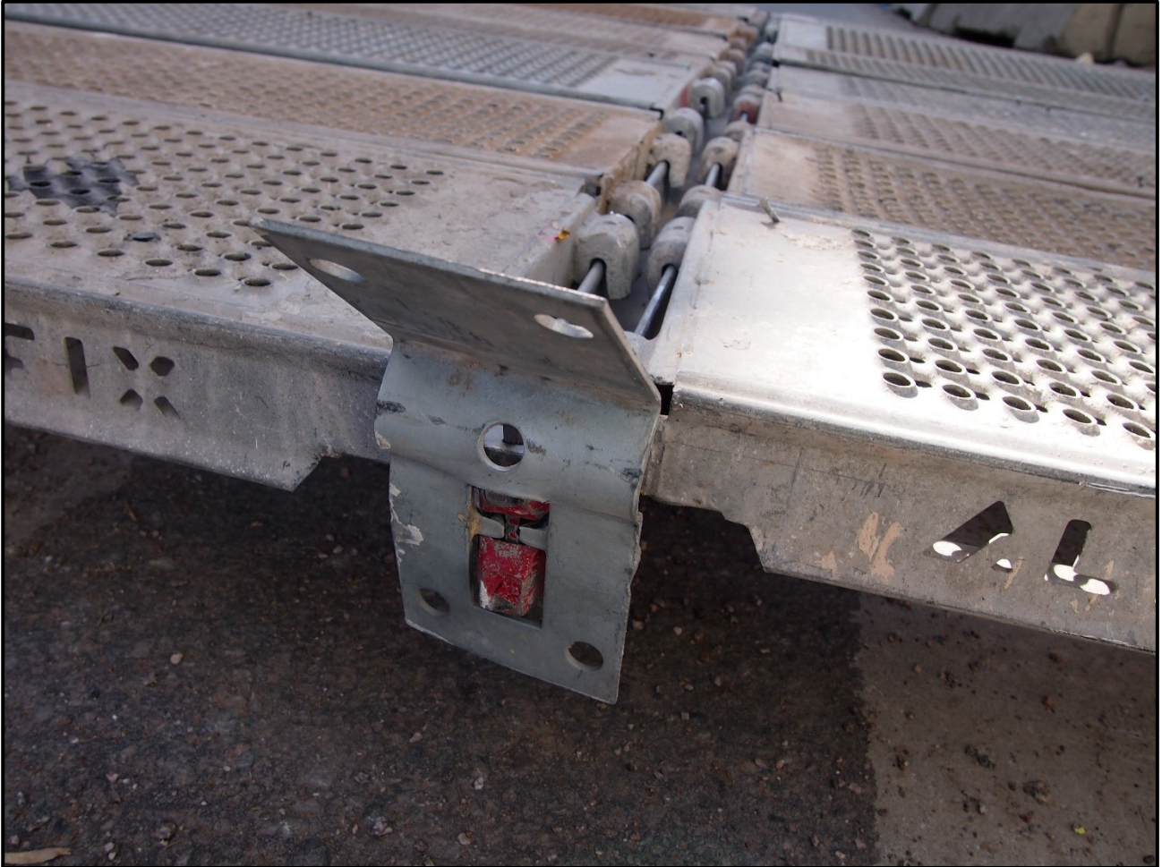
Kuva 7. Auki taipunut sillan kiinnitysosa on asennettu poikittaispalkkiin ja telitasot lepäävät poikittaispalkin varassa. Kuvassa näkyvät rakenteet on koottu onnettomuuden jälkeen, eikä osien sijainnit kaikilta osin vastaa onnettomuustilannetta. (Kuva: OTKES)
