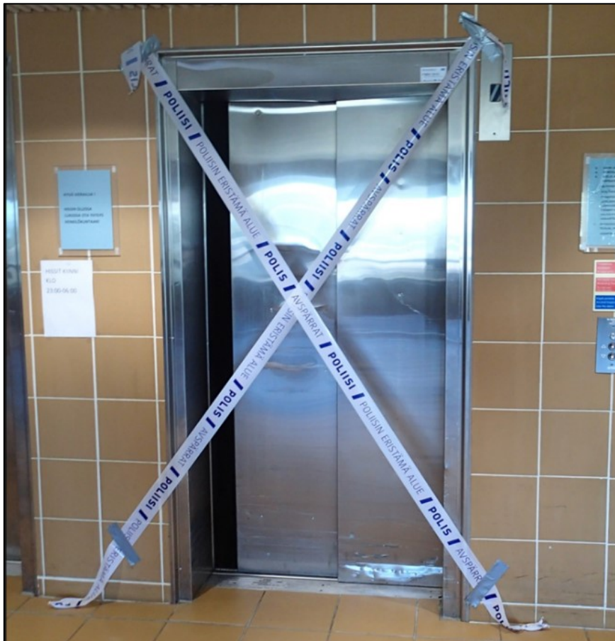
Bild 1. Dörröppningen till hiss nummer tre på våning fyra i tillbyggnaden vid Kauniala sjukhus, där olyckan inträffade (Bild: OTKES)
