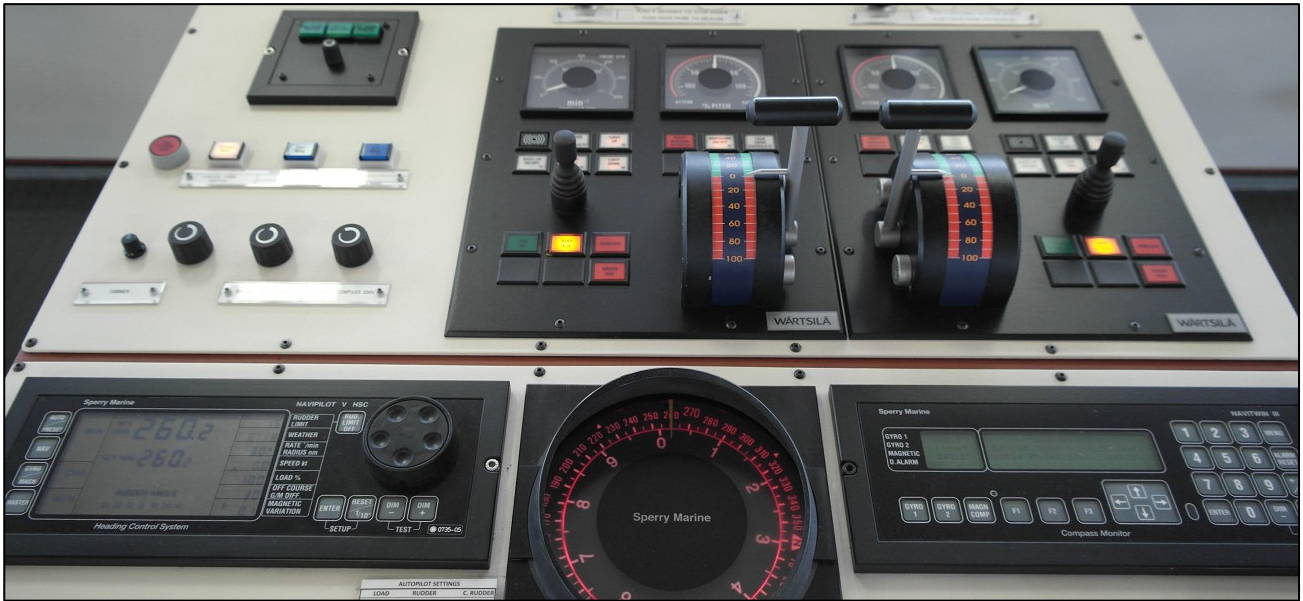
Kuva 10. Kuvassa aluksen ohjailu- ja koneistohallintalaitteet. (Kuva: OTKES)
