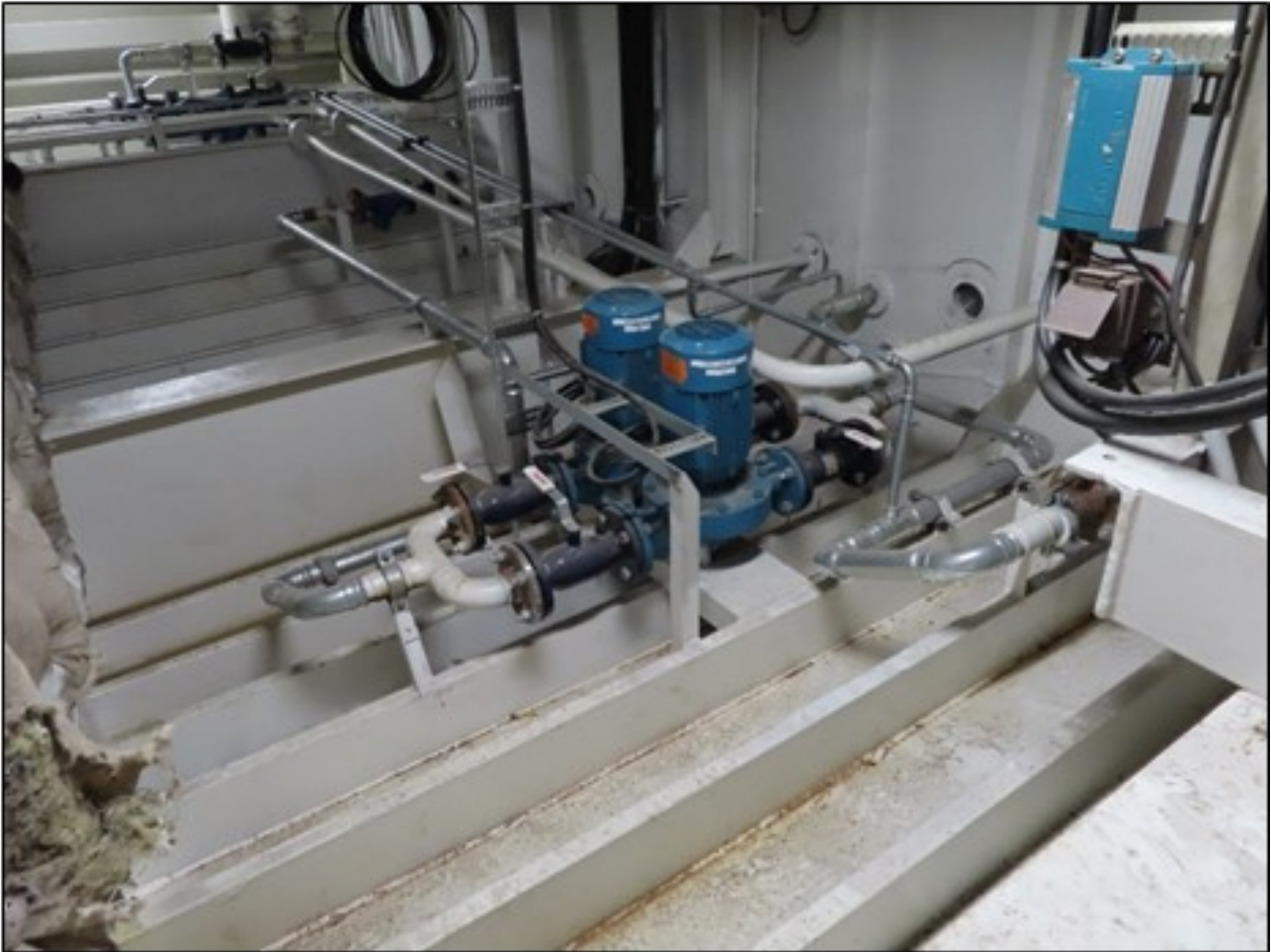
Bild 5. Akterns (mot Nagu) kylpumppar (bild: OTKES)
