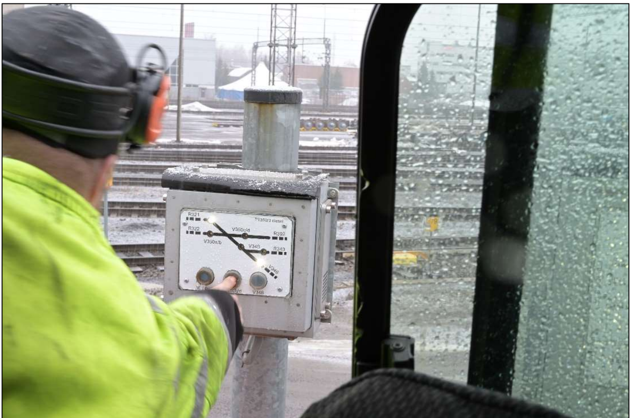
Kuva 4. Veturin ohjaamosta käytettävä vaihteenkääntöpainiketaulu PT350/3 ennen vaihdetta V348. (Kuva: OTKES)
