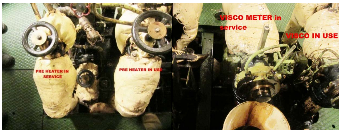
Bild 16a. Anordningar som var under service.
