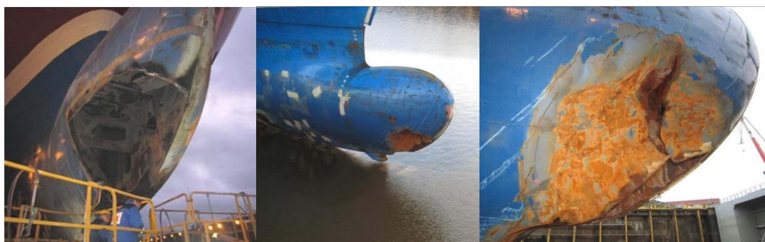
Bild 21. Skador på bulbstäven och bulben öppnad (till höger). Bilder: DNV GL.
