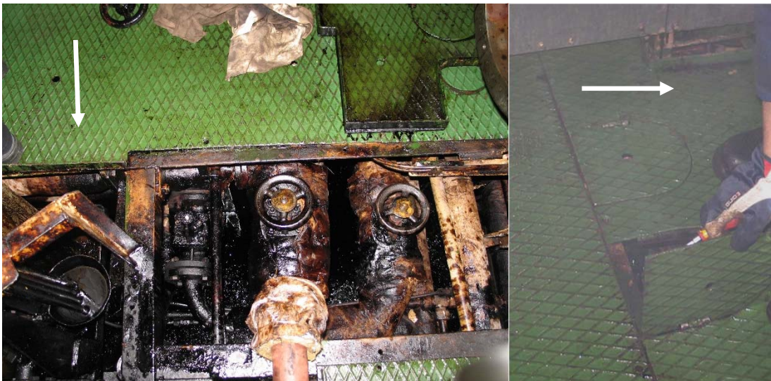
Bild 16c. Området vid viskosimeterns ventiler. Till vänster durkluckorna öppnade 17.12.2013, till höger öppnar man dem 20.12.2013. Bulten till den vänstra ventilen, ventilen till den som var under service, är av. Den brutna bulten syns i bildens övre kant. Förens riktning i bilden är märkt med en pil.
