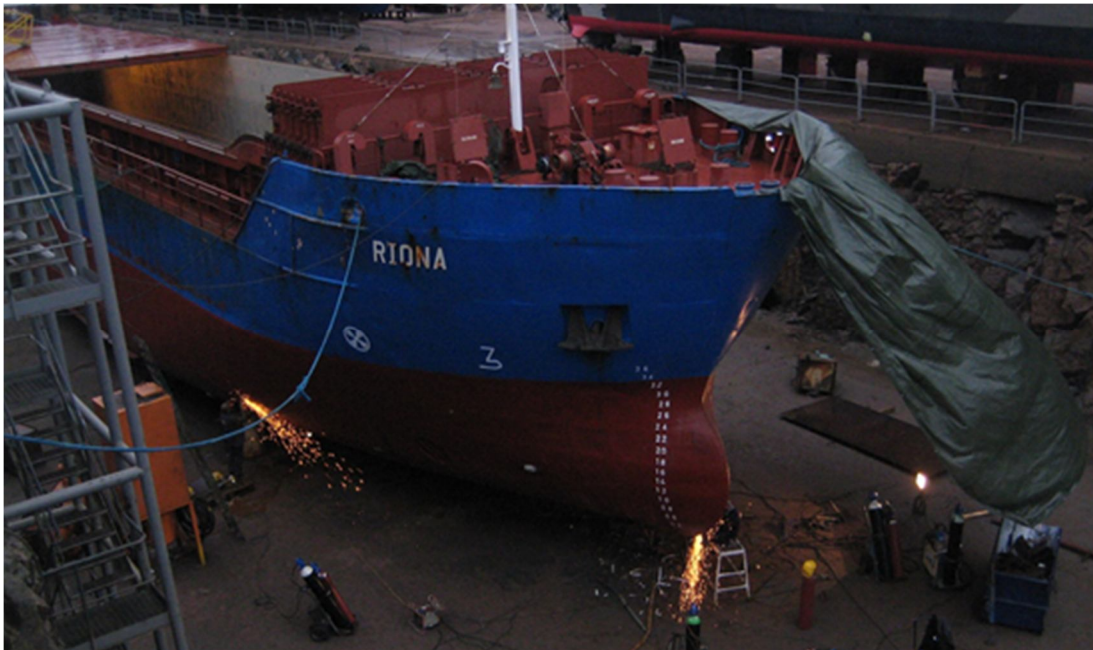
Bild 10. Dockningsfoto. Skadorna skärs ut. (Foto: Olycksutredningscentralen)
