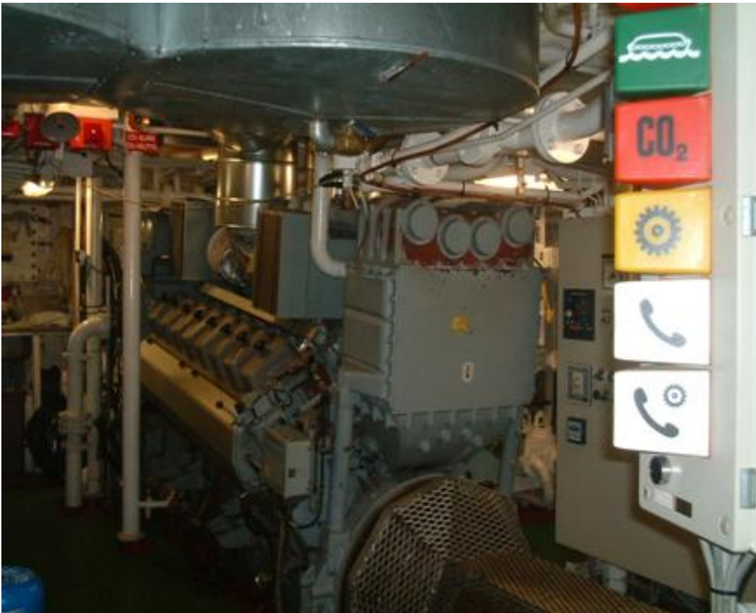
Kuva 3 TELKÄn konehuone. Kuvassa näkyy vasemmanpuoleinen pääkone (© Rajavartiolaitos).
