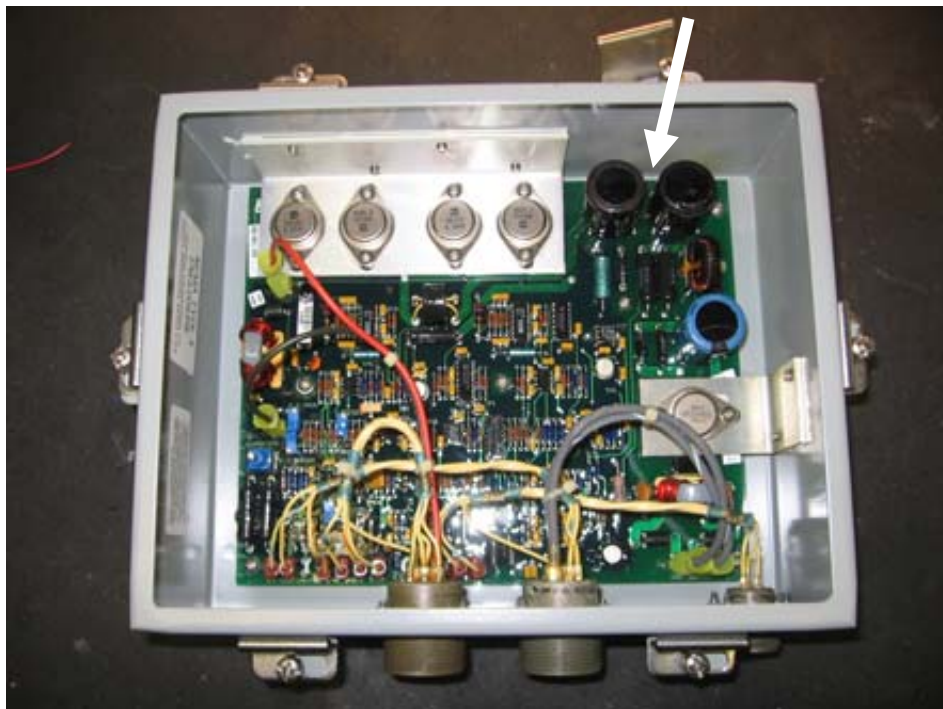
Kuva 7. Pro Act Driver'in kotelo avattuna. Nuoli osoittaa kahta vioittunutta kondensaattoria.
