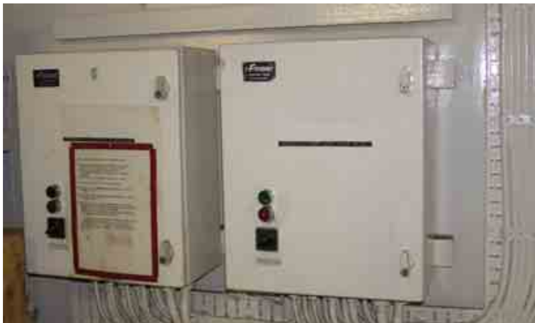
Bild 3. Kopplingskåpena för rodrets hydraulikpumpar. Beskrivningen för nödstyrningen finns på vänstra skåpet.
