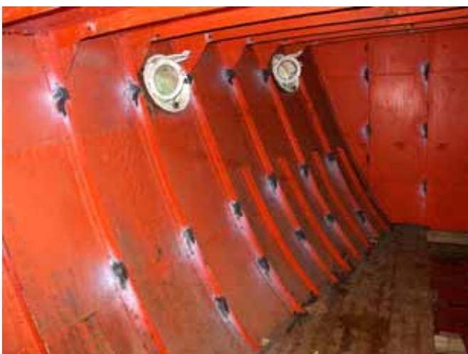
Kuva 16. Valoventtiilit aluksen sisältä nähtynä.
