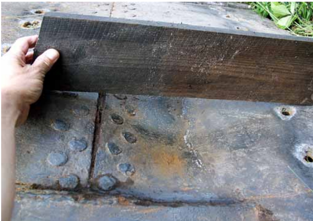
Kuva 10. SB-puolen iskemäkohdan levy irrotettuna. Painuma 400 mm:n kaarivälillä oli noin 75 mm. Lähistön saumat eivät ole revenneet, mutta niittisauma on hieman avautunut säilyttäen silti tiiveytensä.
