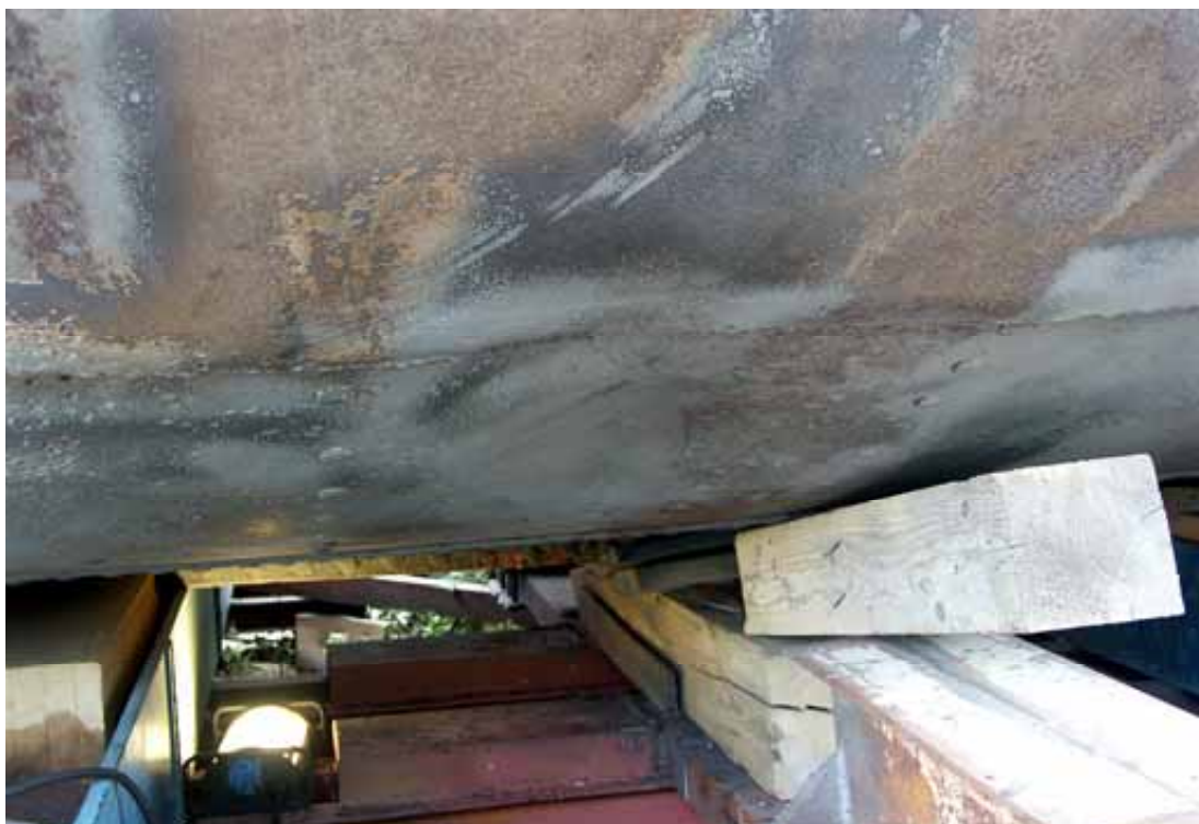
Kuva 9. BB-puolen iskemäkohta. Levy on painunut jouhevasti ja taipunut plastisesti ilman säröilyä.
