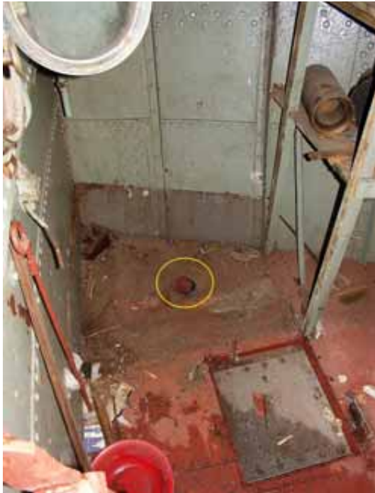
Kuva 13. Käymälätila. Istuin oli sijoitettu kuvassa näkyvän kannen aukon kohdalle ja putki oli viety aukon läpi laidoitukseen.
