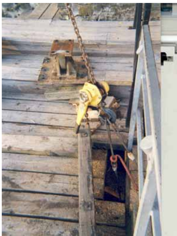
Kuva 25. Sillan kiinteän osan vasemman reunan väliaikaiskiinnitys taljalla rantakalli-oon. Kuvassa näkyy myös vaurioitunut teräskiinnike irrotettuna.
