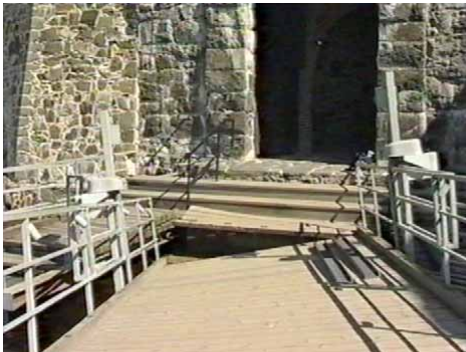
Kuva 24. Sillan kiinteän osan vaurioitunut kiinnitys (vrt. kuva 41).
