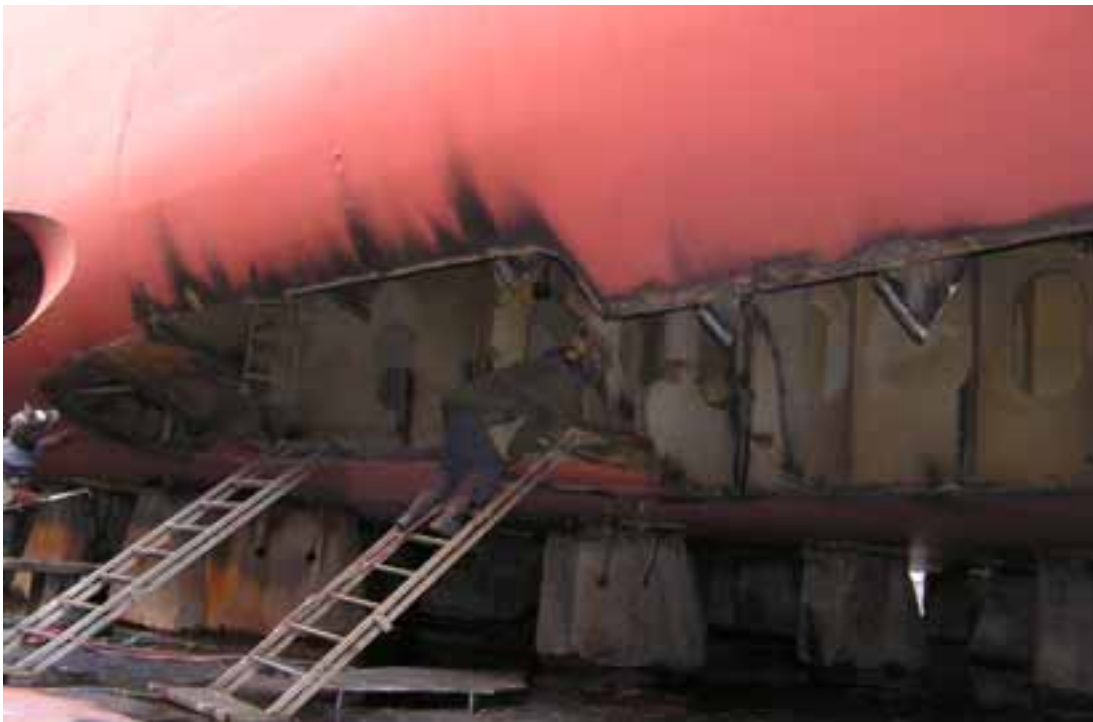
Kuva 13. Vaurioitunutta aluetta poisleikattuna perän vasemmalla puolella.
