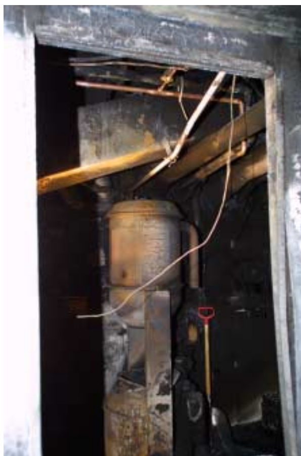
Bild 6. Centralsugarrum, skärbrännarens låga gick genom taket.
