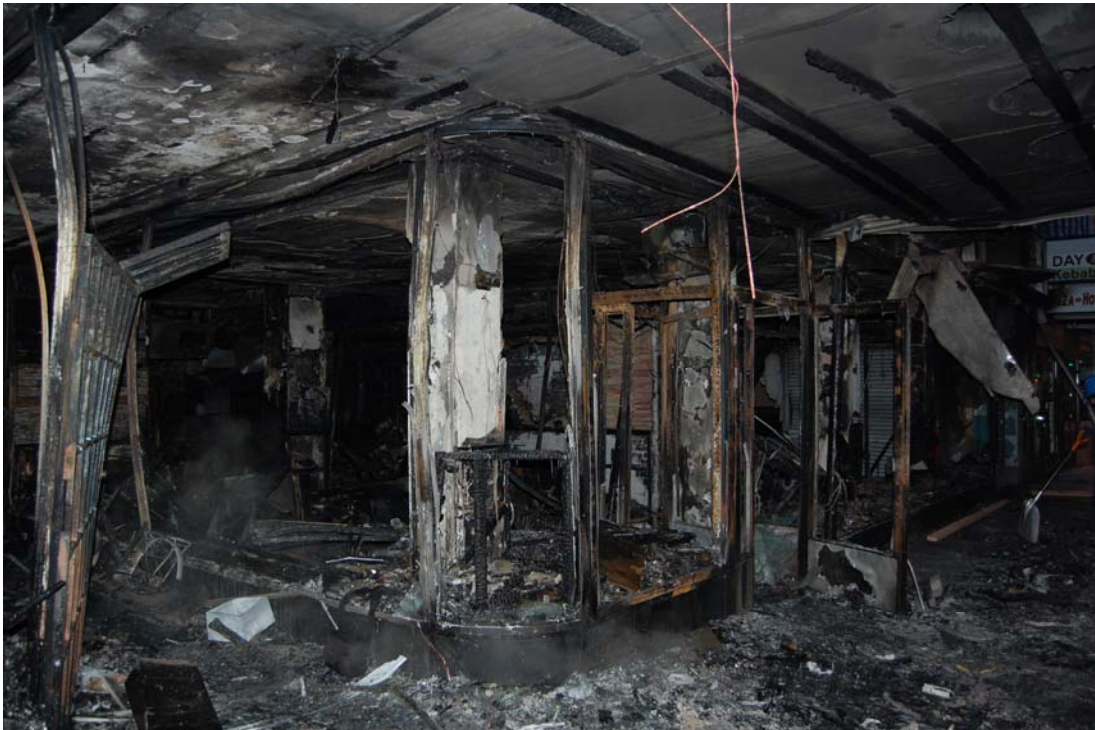
Kuva 4. Pizzerian sisätilat tulipalon jälkeen.
