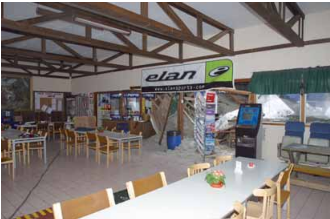
Kuva 3. Kuva vaurioituneesta hallista ulkoa ja kahvilan suunnasta kuvattuna sisältä. Kuvassa näkyvät puiset ristikot kuuluvat sisäkattorakenteeseen.
