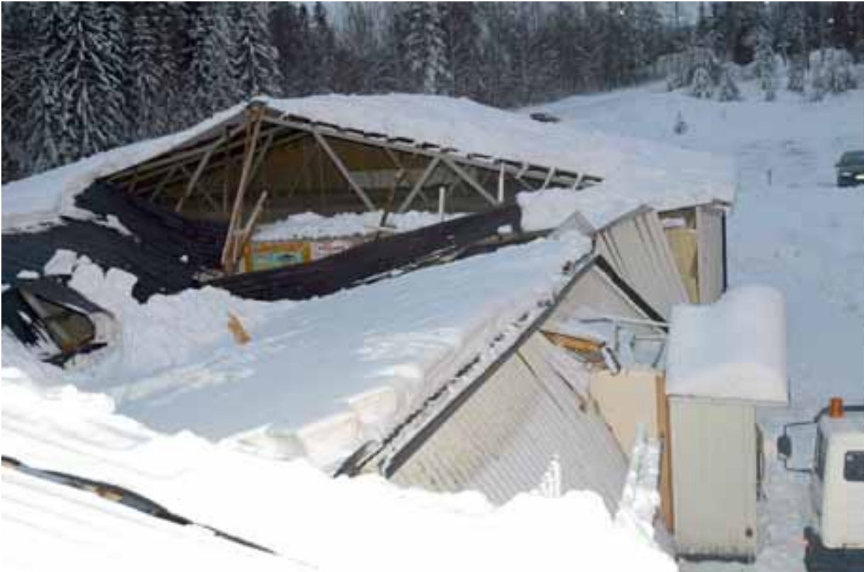
Kuva 1. Valokuva räystäään suuntaisesti. Kuvassa näkyy kattoristikon yläpaarteiden taipuminen ja kattoristikon keskimmäisten diagonaalien puuttumisen vaikutus kestävytyteen.
