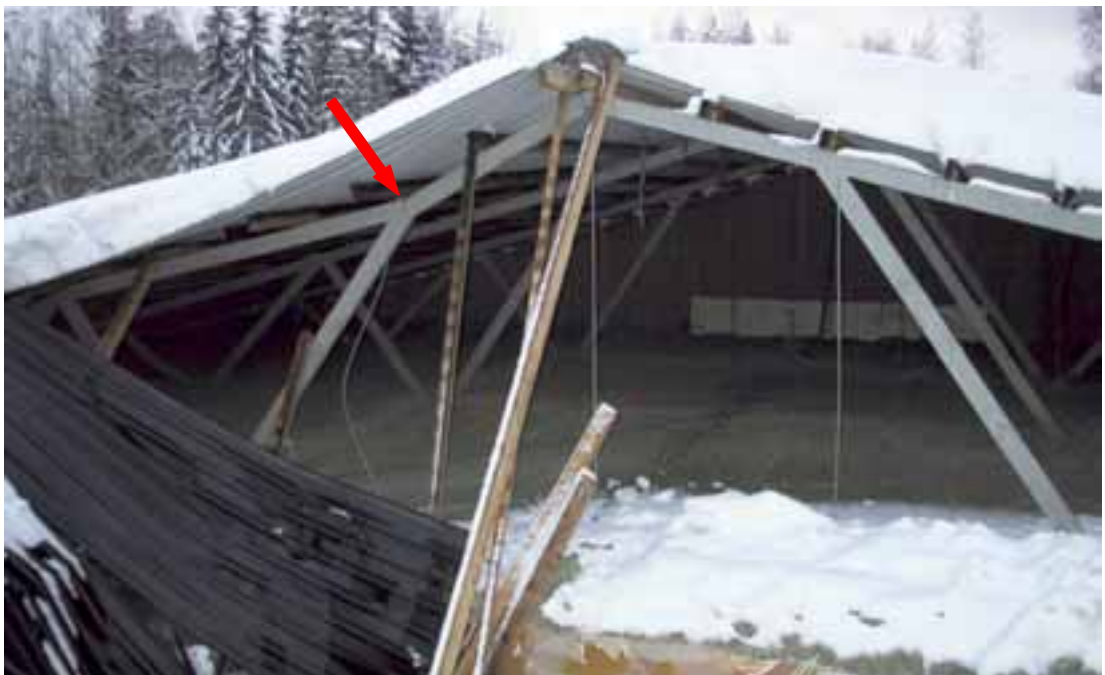
Kuva 6. Kohta, josta kattoristikoiden pettäminen alkoi. Kuvan vaurio on ristikossa, joka ei pudonnut.
