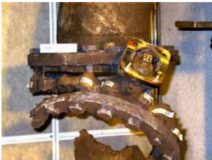
Kuva 17. Venttiilin putkistoon liittävien kiinnitysruuvien röntgenkuvaus suoritettiin sen selvittämiseksi olivatko käytettyjen ruuvien pituudet oikeat. Kuvaus ei paljastanut virheitä asennuksessa.
