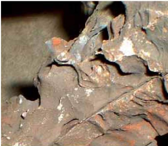
Kuva 10. Vaihteen puoleisen läppäakselin (ensiöakseli) alue palaneessa venttiilissä. Ylemmässä kuvassa akselin pää indikoitu punaisella ja venttiilirungon ja putkilaipan liitos valkealla viirulla. Laakeriholkin yläpuoli palanut täysin, alapuolelta jäljellä noin 5 mm. Rungon sisäpinnalta palanut noin 25 mm kerros, käsittäen laakeriholkin alueesta 20 mm ja holkin upotusosan noin 5 mm.
