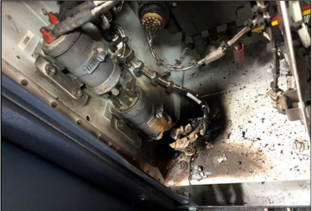
Bild 4. Det brända reläet för avisningssystemet för propellern, bilden har tagits innan felet reparats. (Bild: Norra)
