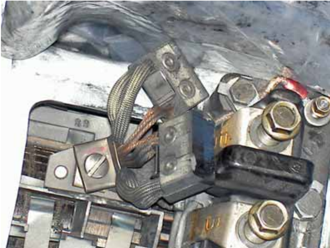
Kuva 1. Lyhyeksi kuluneet hiilet ja voimakkaan kipinöinnin jäljet kommutaattorin pinnassa
