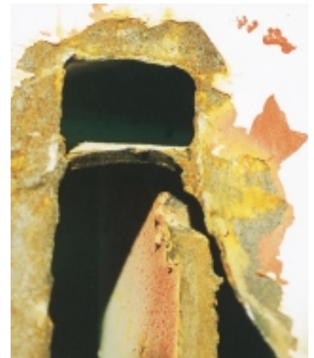
Kuva 12.23 Oikeanpuoleisen sivulukkolenkin irtoamiseen liittyvä murtuma vaakajäykkäjän kohdalla.
