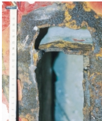
Kuva 12.22 Vasemmanpuoleisen sivulukkolenkin irtoamiseen liittyvä murtuma vaakajäykkäjän kohdalla.
