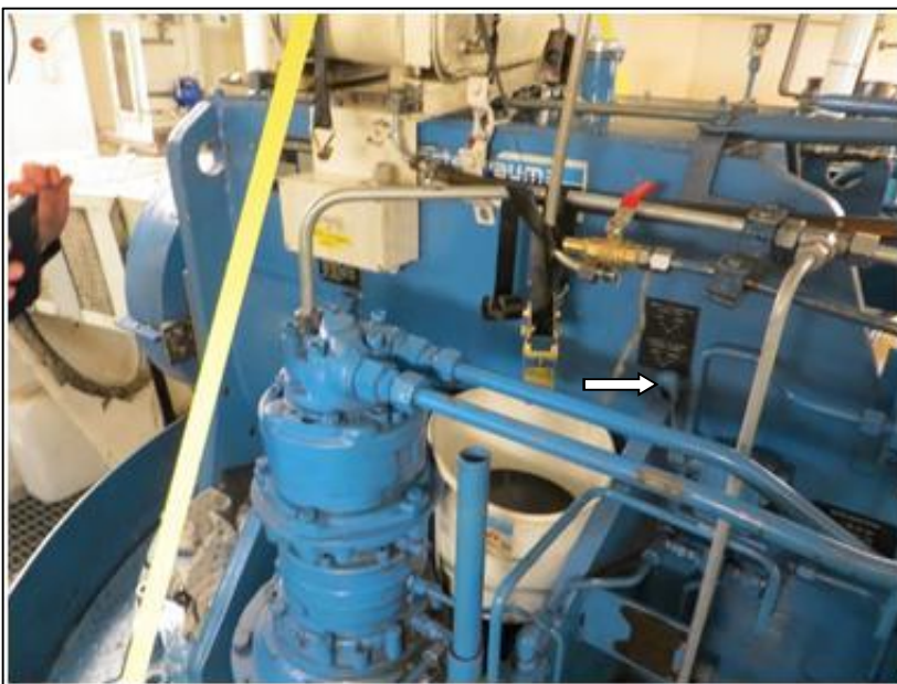
Kuva 8. Hydraulimoottori ja nuolella osoitettu jarrun kytkentävipu (Kuva: OTKES)
