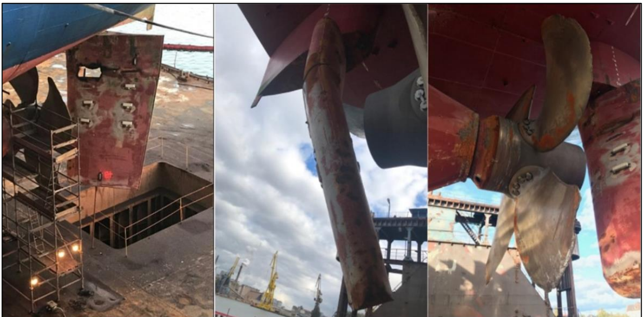
Kuva 4. Aluksen vaurioitunut peräsin vasemmalla, taipunut peräsintukki keskellä ja vaurioitunut potkuri oikealla. (Kuvat: Leonhardt & Blumberg, Shipmanagement GmbH & Co. KG)
