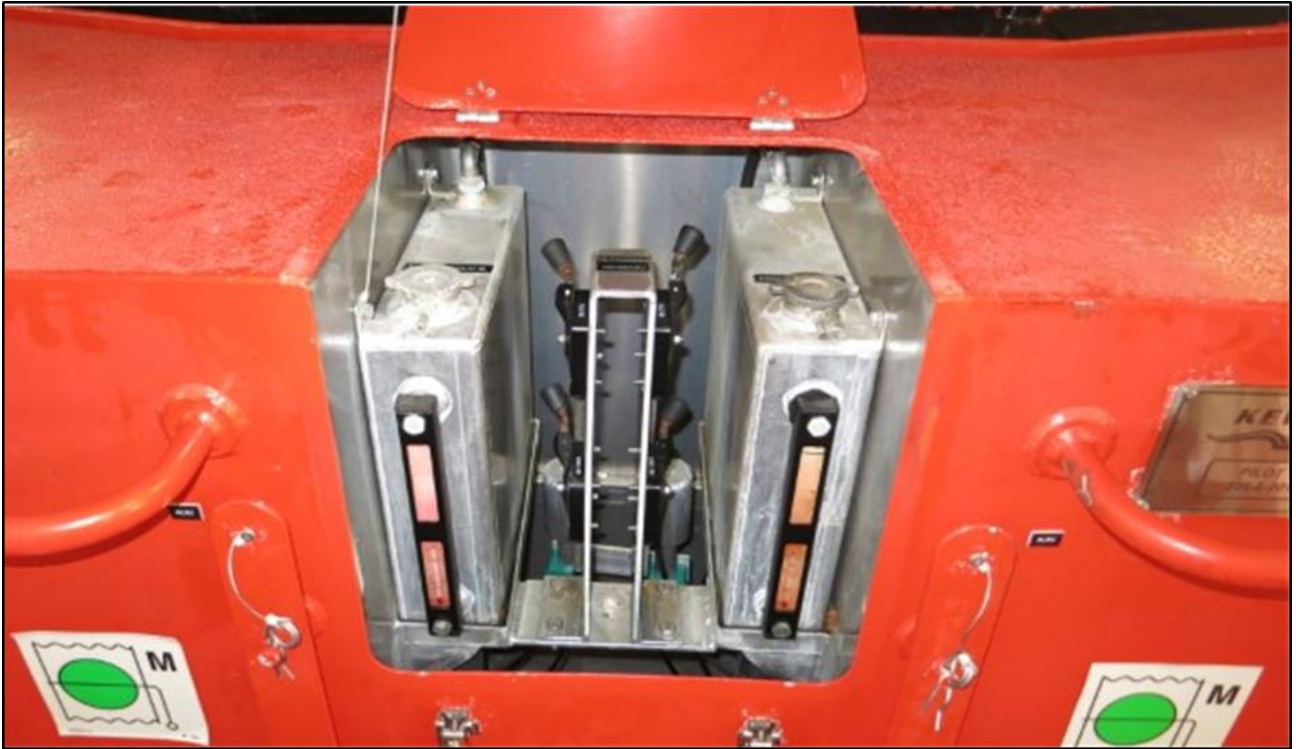
Kuva 16. Polttoainesäiliöiden pikasulkuventtiilit ja konehuoneen ilmanottoaukkojen sulkukahvat. (Kuva: OTKES)
