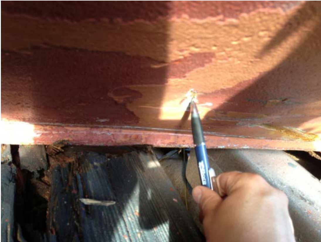
Kuva 6. Aluksen oikealla puolella oli terävä painauma, joka oli aiheutunut karilleajosta. (Kuva: Otkes)
