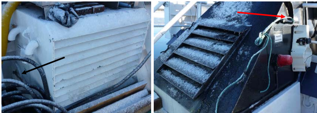
Kuva 9. Konehuoneen tuuletuksen ilman sisäänottokanavan (vasemmalla) ja poistoilmakanavan (oikealla) palopellit on osoitettu nuolilla. Katso myös kuva 1. Kuvattu 1.2.2013.
