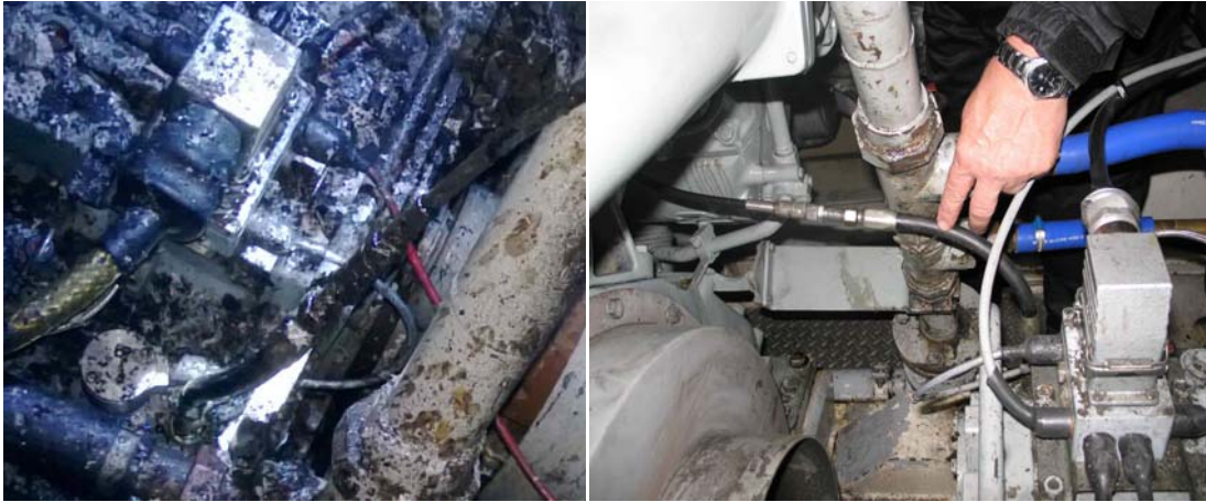
Kuva 13b. Pääkoneen alennusvaihteen öljynpaineen mittarille johtava putki oli palon jälkeen rikki. Vasemmalla kuvattuna 28.1 (Rauma Survey) ja oikealla 31.5.2013 kuvattuna.
