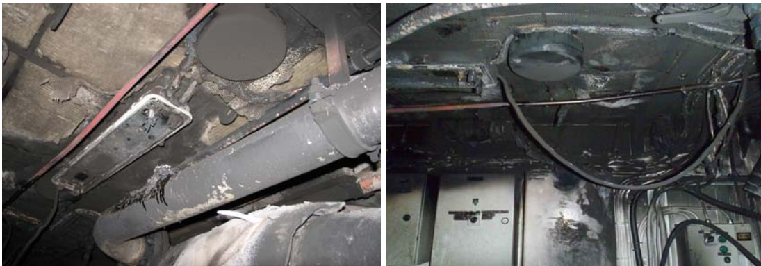
Kuva 12. Palovaurioita konehuoneen katossa.
