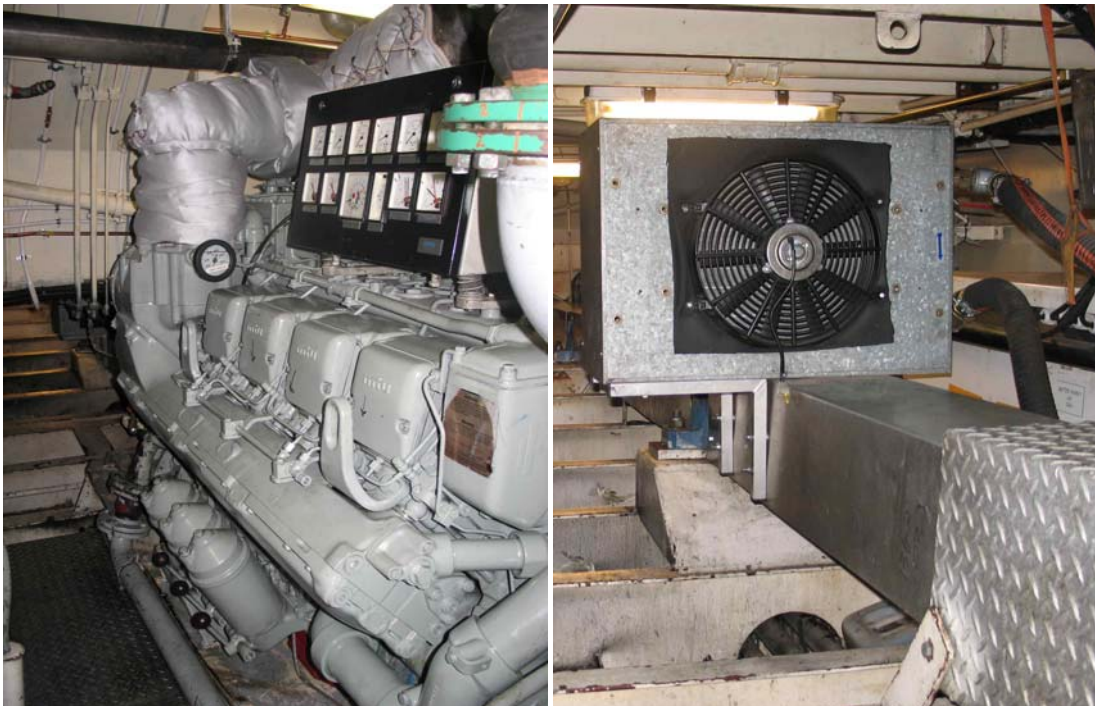
Kuva 4a. Vasemmalla pääkone SB-puolelta, taustalla alhaalla akselitunneli. Kuvassa oikealla akselitunnelissa sijaitseva puhallin pääkoneen jäähdytyksen parantamiseksi. Kuvattu 31.5.2013.
