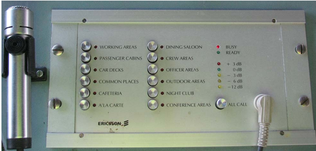
Kuva 11a. Kommentosillalla sijaitseva kuulutusjärjestelmän ohjaustaulu.
