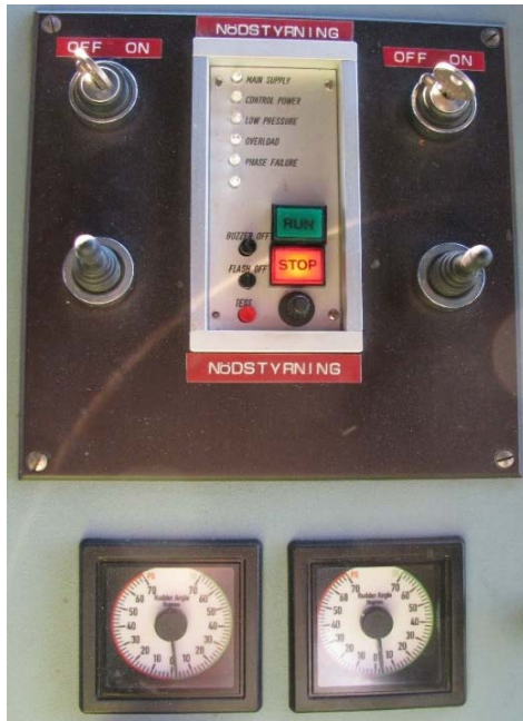
Kuva 10a. Komentosillan vasemmanpuoleisen pulpetiston keskipulpetissa sijaitsee hätäohjauspaneeli (paineakkuohjaus).
