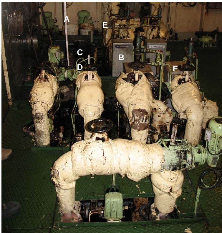
Kuva 6b. Yleisnäkymä 16.12.2013 huoltotyön alueesta. Apukoneiden lämmönvaihtimet näkyvät taaempana.
