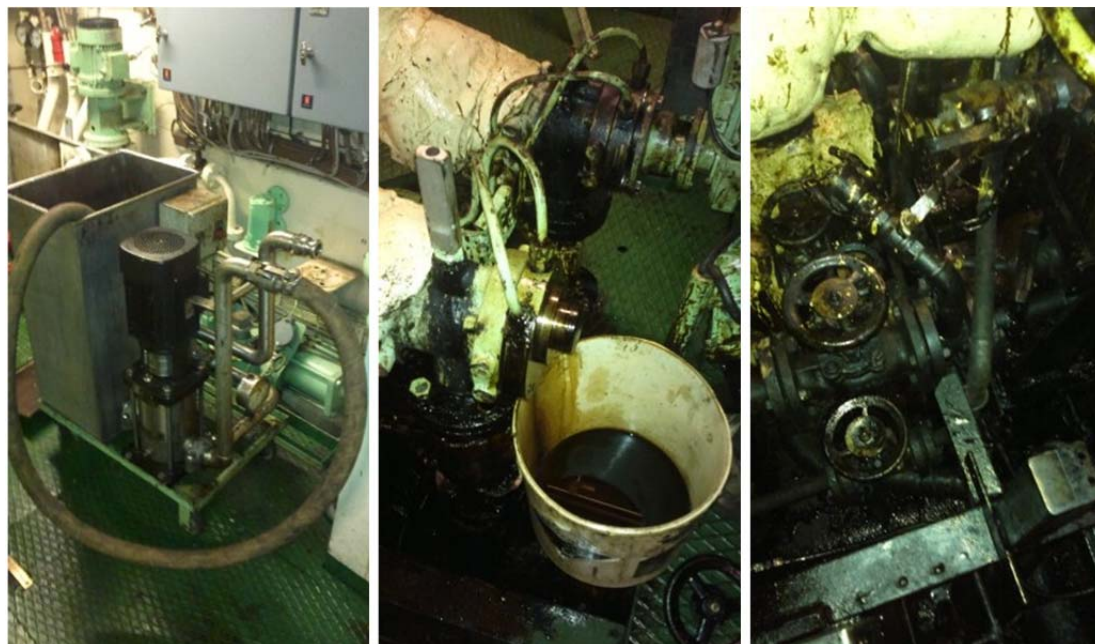
Kuva 16b. Vasemmalla apukoneiden HFO-esilämmittimien pesulaitteistoa, keskellä viskosimetrin kiinnityslaippa, josta vuoto tapahtui ja oikealla HFO:n tahrinää pilssiä lähellä vuotokohtaa. Kuvattu 16–17.12.2013.
