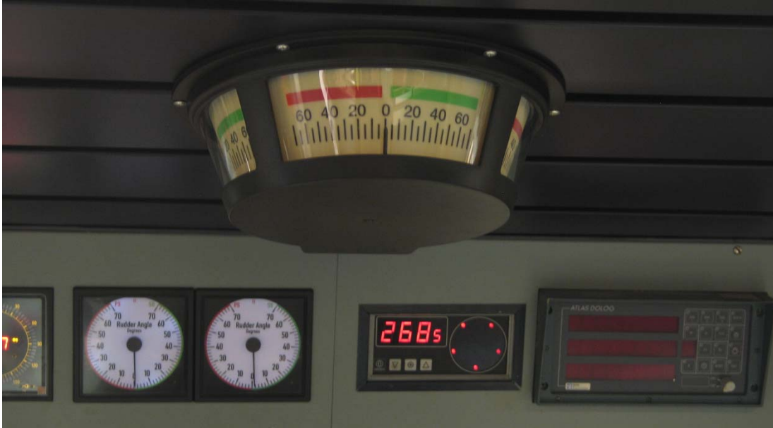
Kuva 3. Komentosillan kattokonsolin näyttölaitteita. Katossa kolmeen suuntaan näyttävä osoitin ja vasemmalla tyypilliset viisariosoittimet.
