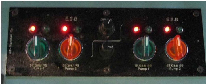
Kuva 10b. Peräsinkoneiden pumppujen käynnistyskytkimet ohjauspaneelissa. Punaiset kytkimet on kytketty hätäsähköverkkoon
