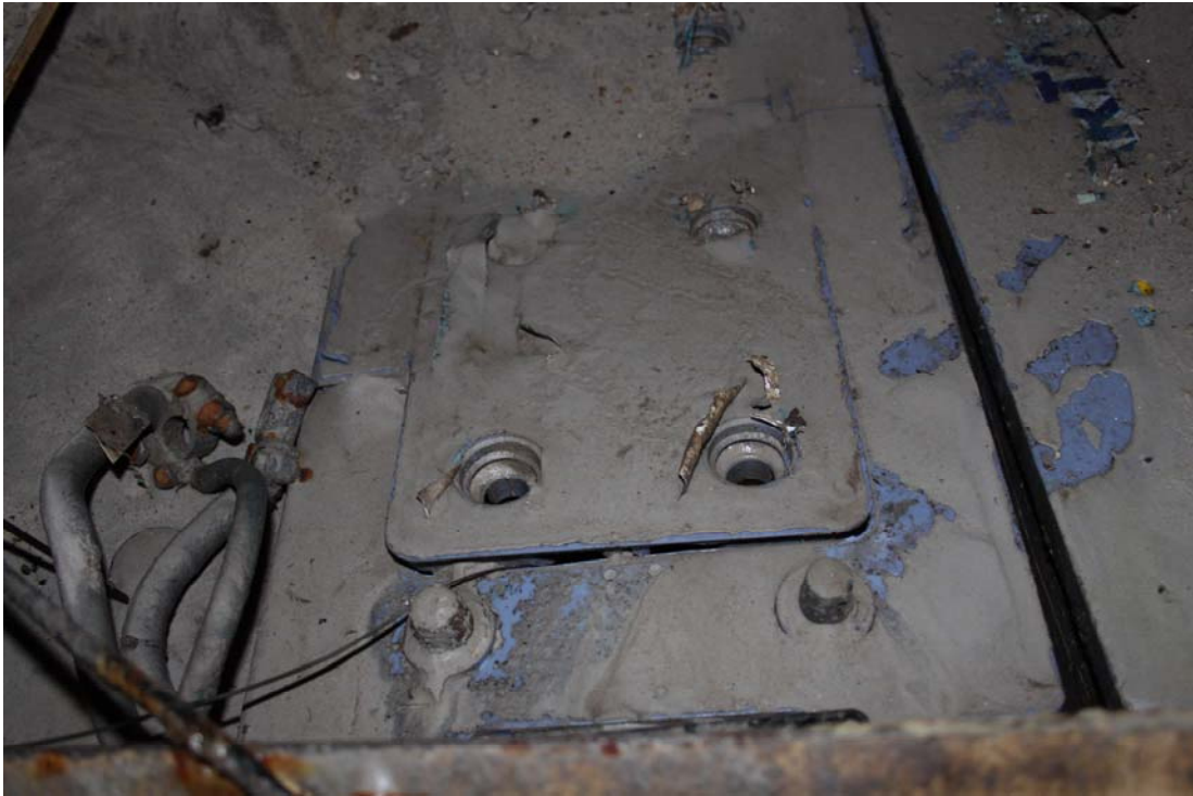
Kuva 7. Pääkoneen yhden 12 V käynnistysakun kennostojen tulpat ja kansi olivat irronneet räjähdysmäisesti. (Kuva:OTKES)
