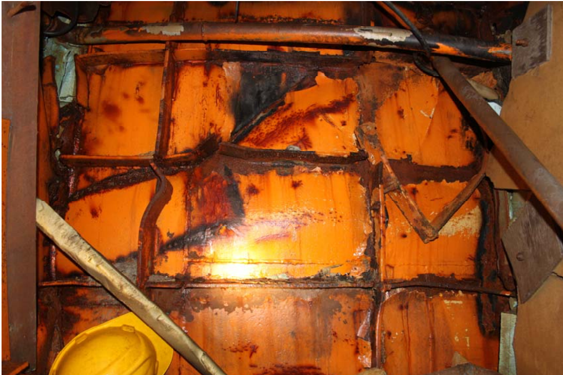
Kuva 5. Sisäpuolelta kuvattuna oikean kyljen vääntyneitä ja irronneita runkolevytyksen jäykkäjiä. (Kuva: OTKES)
