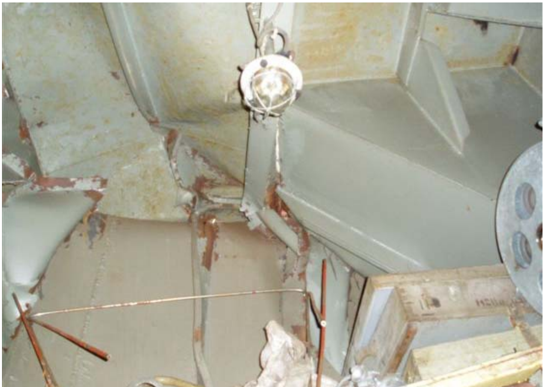
Kuva 9. Samat vauriot LAIMAn keulakorokkeen sisäpuolelta.
