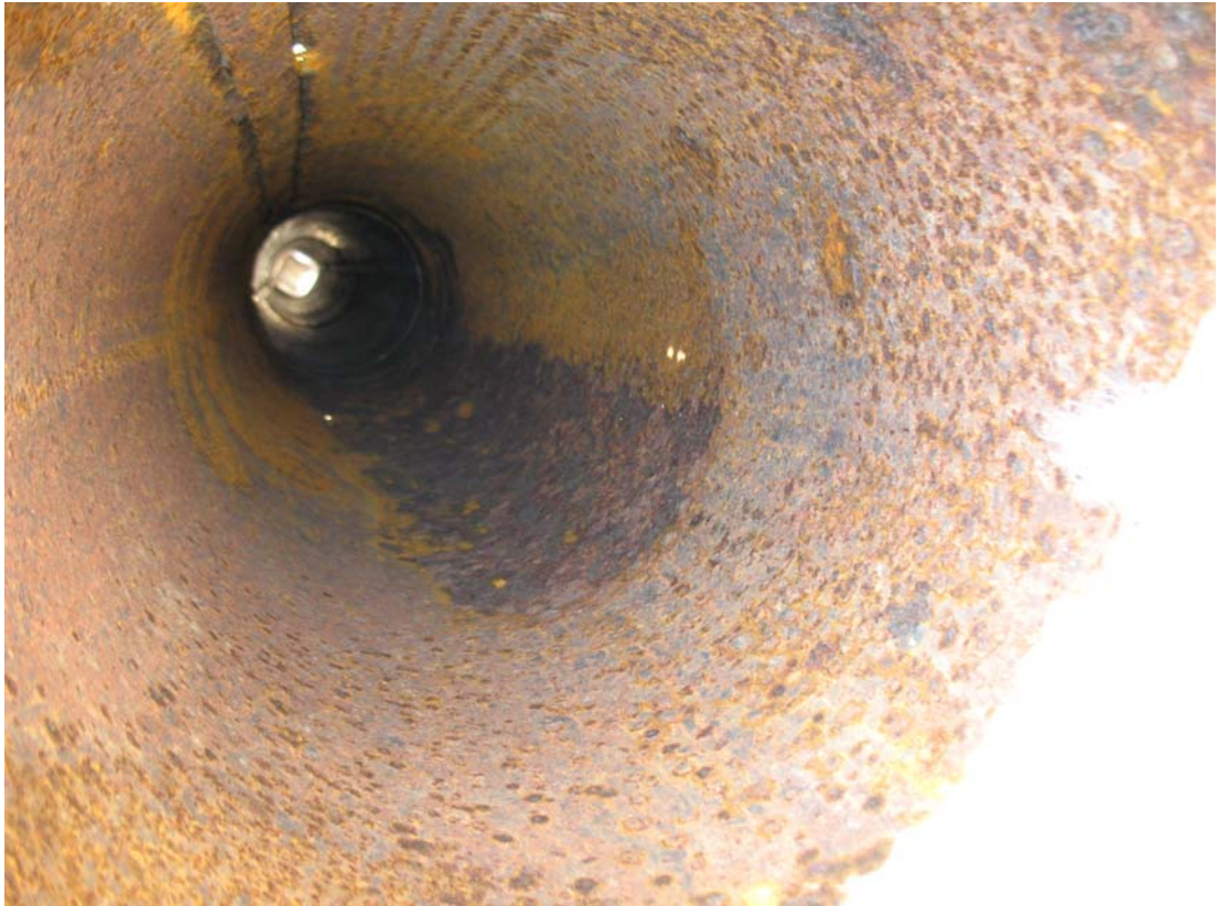
Kuva 10. Maston sisäpuoleista ruosteisuutta. (MKL)
