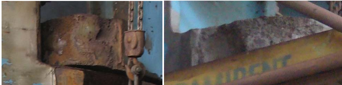
Kuva 13. Peräsinsarven kavitaatiosyöpyimiä. Vasemmalla BB (kuvattu 3.12), oikealla SB (Trafin kuva 4.12), molemmat keskilaivan puolella.
