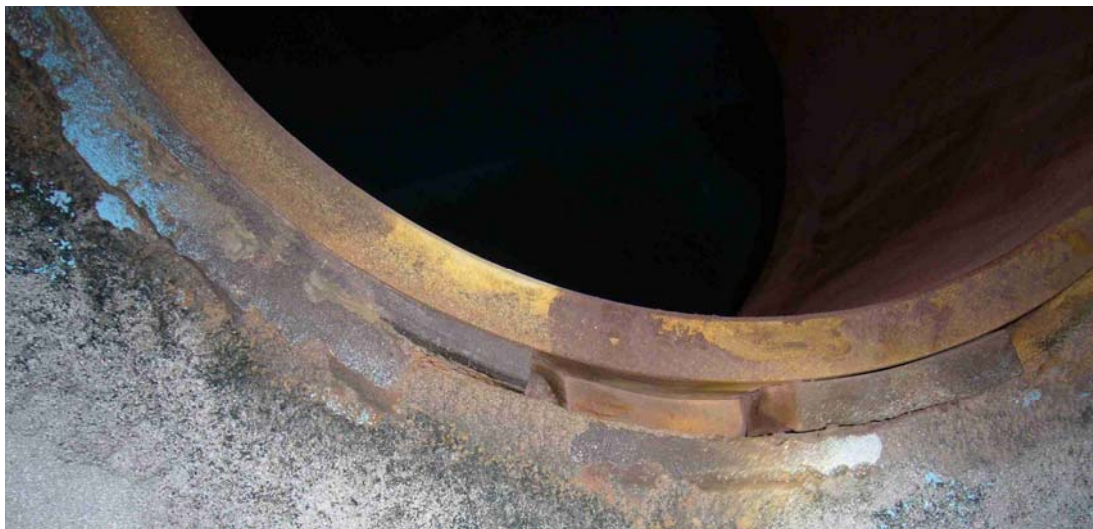
Kuva 24. Osittain irronnutta epoksia BB alalaakerissa. Näkyvissä on selvästi ohuet raot toisaalta epoksin pesän, toisaalta epoksin ja pronssiholkin välissä. Kuvattu 3.12.2009.
