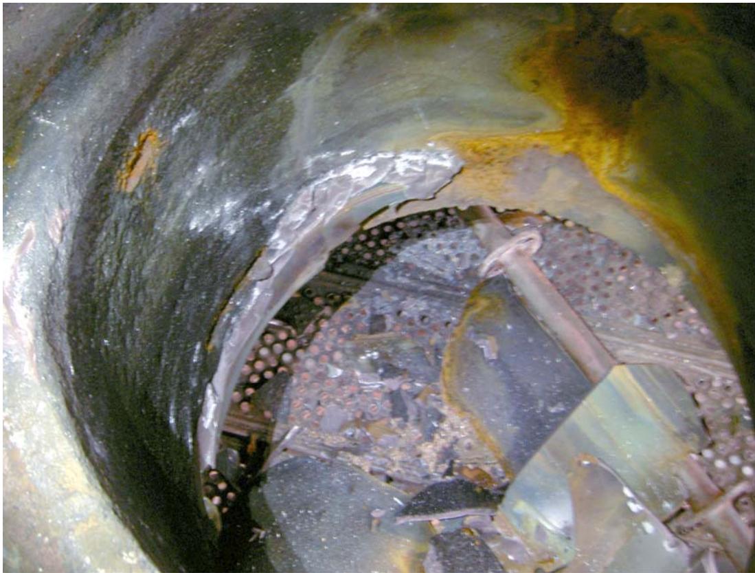
Kuva 29a Epoksin irrotus menossa BB-puolella (Trafín kuva 5.12.2009).
