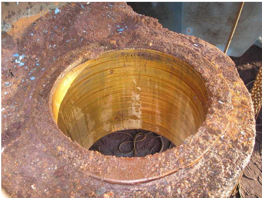
Kuva 44c. BB-alalaakeri kuvattuna ylhäältä 3.12.2009. Näkyvissä on epoksitäytteen lieri ja asennusruuvien päitä holkin rei'issä.
