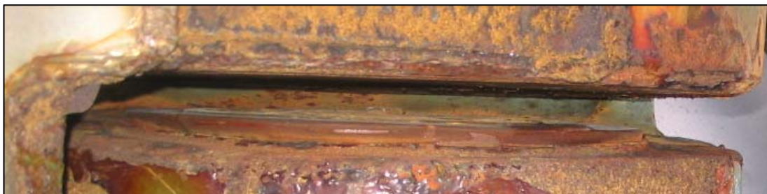
Kuva 28c. Suurennos vasemmanpuoleisesta kuvasta. Näkyvissä on ala-akselin yläpää, jonka reunassa on epoksia. Ympäristö on ruosteessa.
