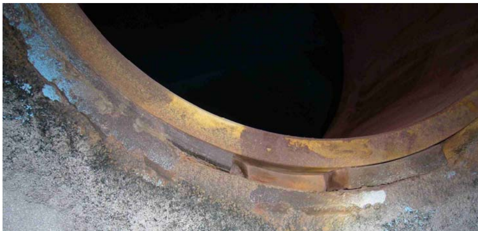
Kuva 44a. Osittain irronnutta epoksia BB-alalaakerissa. Näkyvissä on selvästi ohuet raot toisaalta epoksin pesän, toisaalta epoksin ja pronssiholkin välissä. Kuvattu 3.12.2009.
