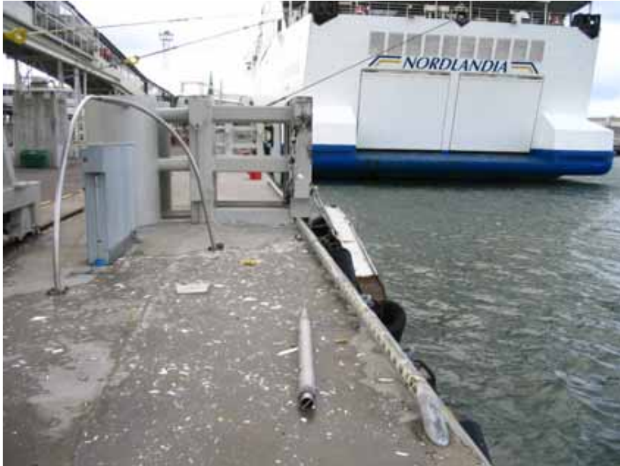
Kuva 21. Laiturin vaurioitunut törmäysvaimennin (fenderi).
