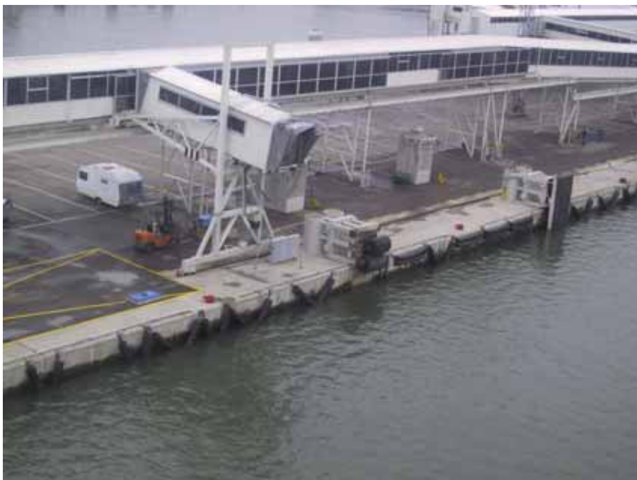
Kuva 22. Etualalla laiturin matkustajasilta ja fenderi, joita NORDLANDIAN törmäys vaurioitti. Kuvassa vasemman puoleinen vaurioitunut fenderi on väliaikaisesti korjattu ja oikealla näkyy ehjä fenderi.
