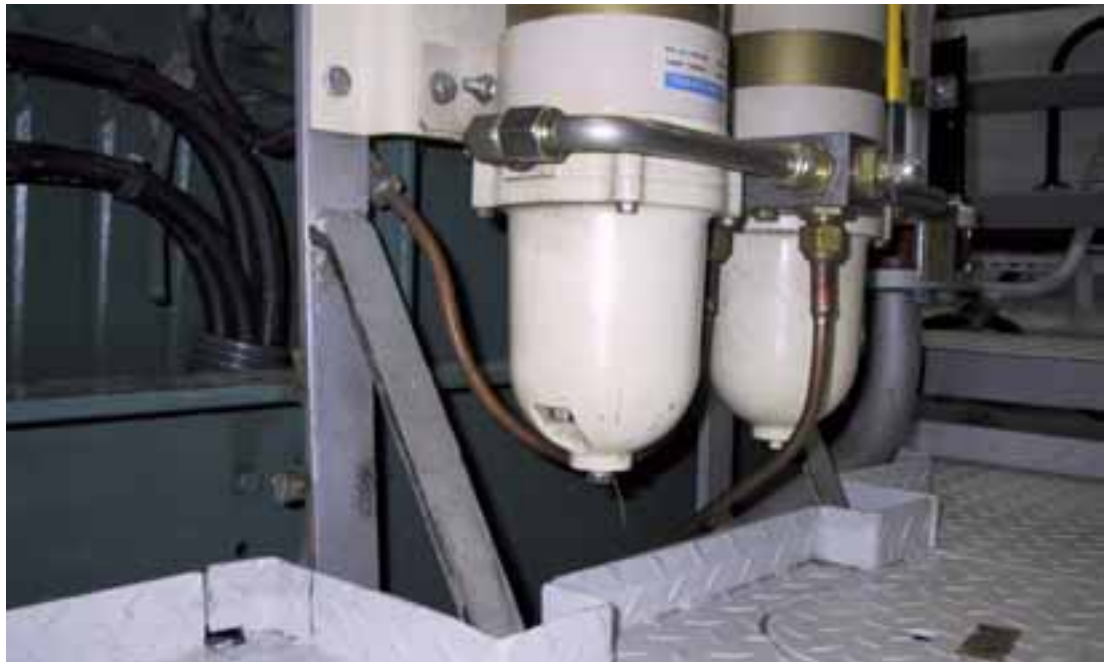
Kuva 8. Ylemmässä kuvassa on nuolella osoitettu polttoainetta konehuoneen alapuolisesta säiliöstä imevä pieni pumppu. Alemmassa kuvassa on polttoainesuodattimet, joihin tulee alhaalta kuparinen sisähalkaisijaltaan 8 mm imuputki, jonka pituus oli koneella 3 lähes 7 m. Polttoaineen imukorkeus oli polttoaineen määrästä riippuen 1,0–1,8 m.
