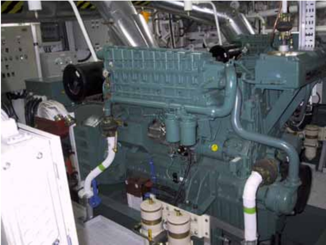
Kuva 7. Kone nro 3. Vasemmalla on generaattori ja etualalla polttoainesuodattimet.
