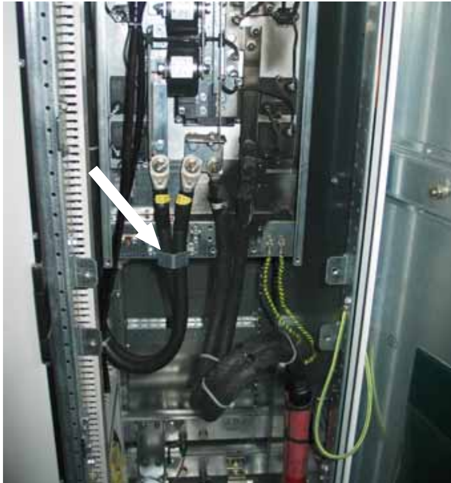
Kuva 9. Kuva palaneista kaapeleista, joista on oikosulun jälkeen poistettu samanlainen teräksinen kiinnitysosa kuin vasemmanpuoleisissa kaapeleissa on (nuoli). Myös teräsosan ympärillä olisi hyvä olla eriste, jotta se ei pääsisi kiristettäessä vaurioittamaan kaapelin eristettä.
