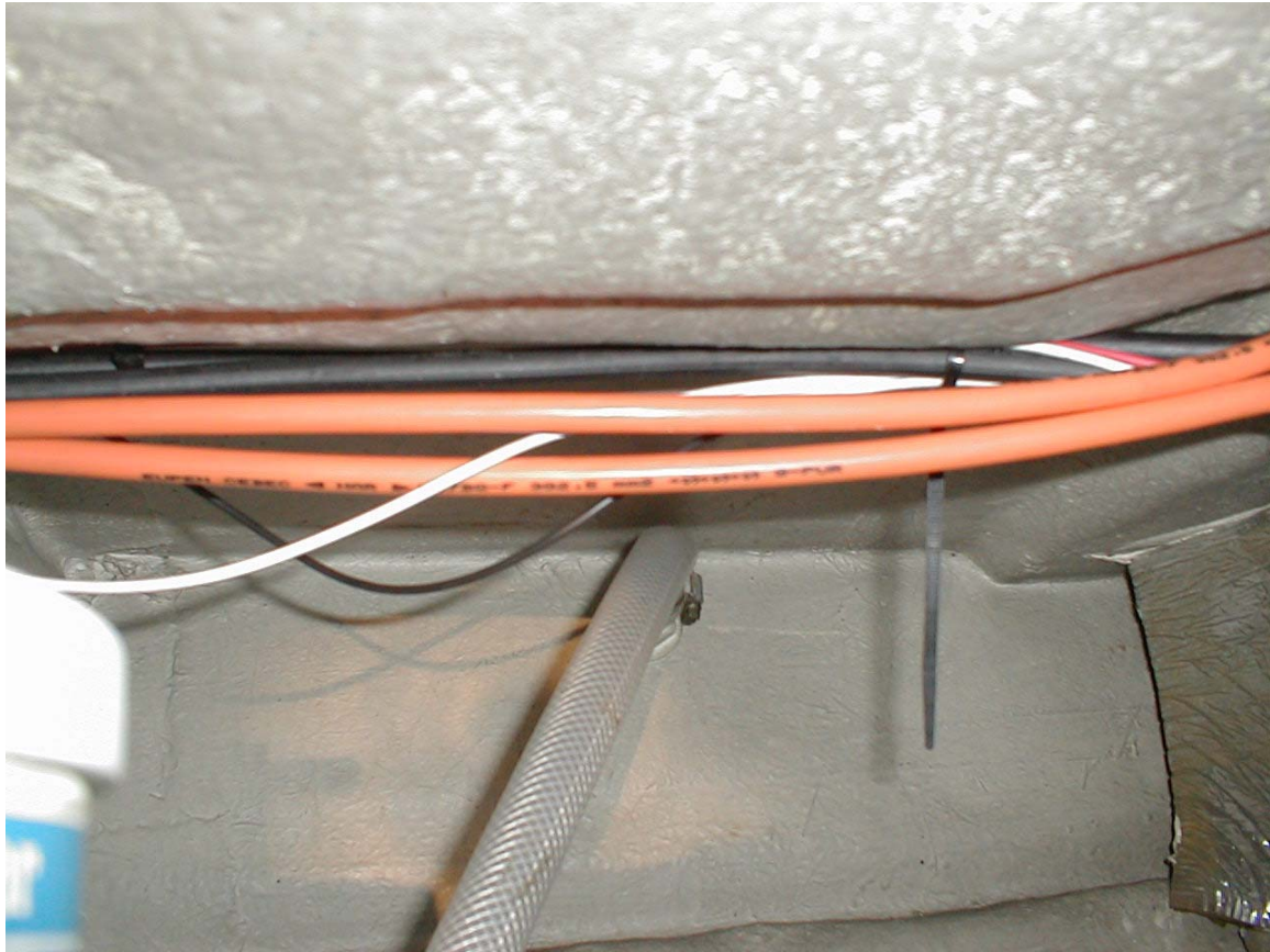
KUVA 7. Etummainen pilssipumpun tyhjennysputki BB
