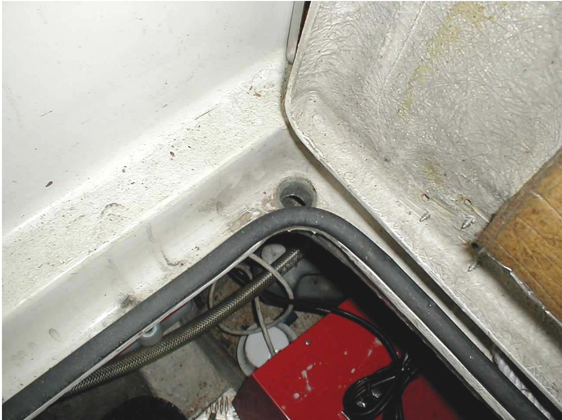
KUVA 3. Konehuoneen luukku ja itsetyhjennys (tiiviste lisätty onnettomuuden jälkeen)
