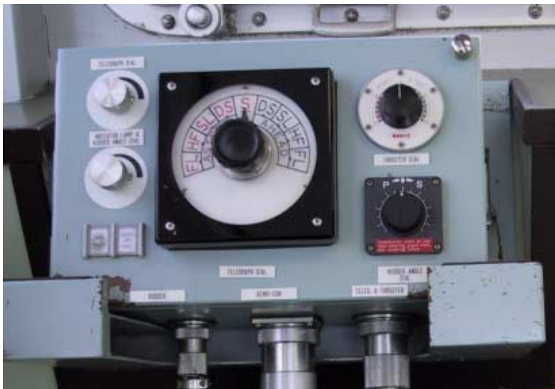
Kuva 5. Hallintalaite, joka oli komentosillan vasemmalla siivellä.
