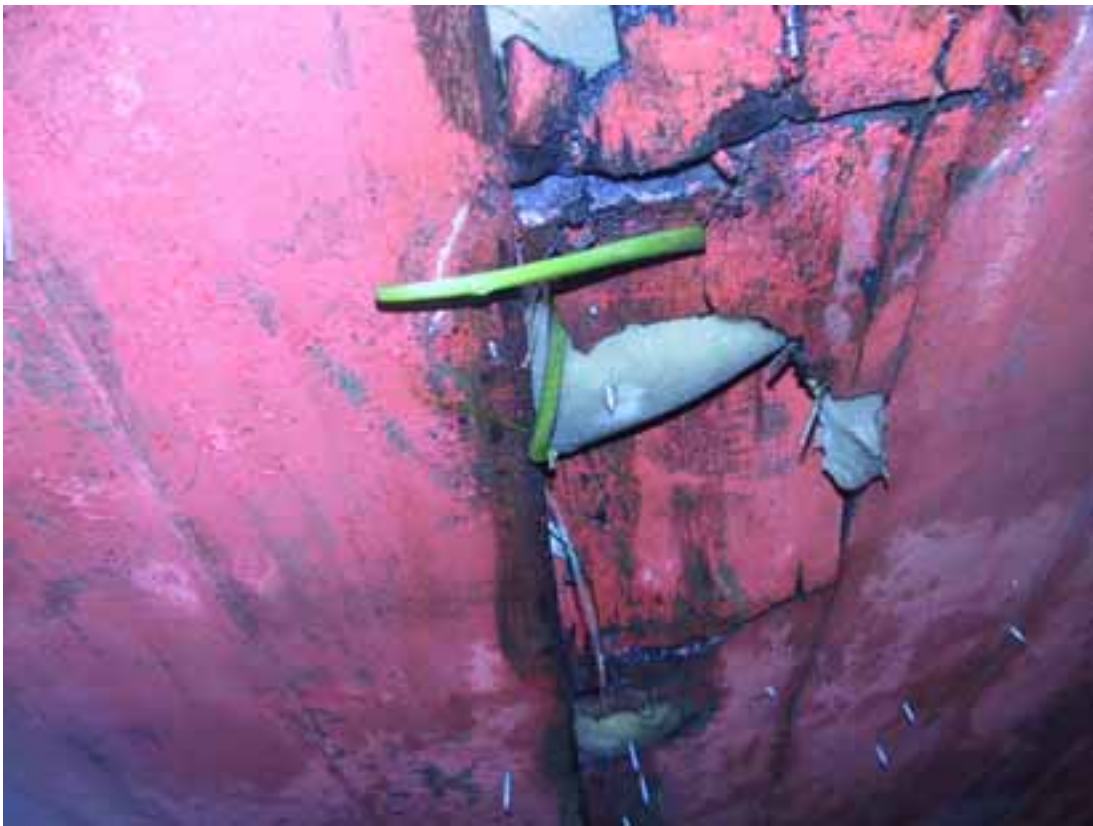
Kuva 4. Pohjan vaurioita tilapäiskorjauksen jälkeen.
