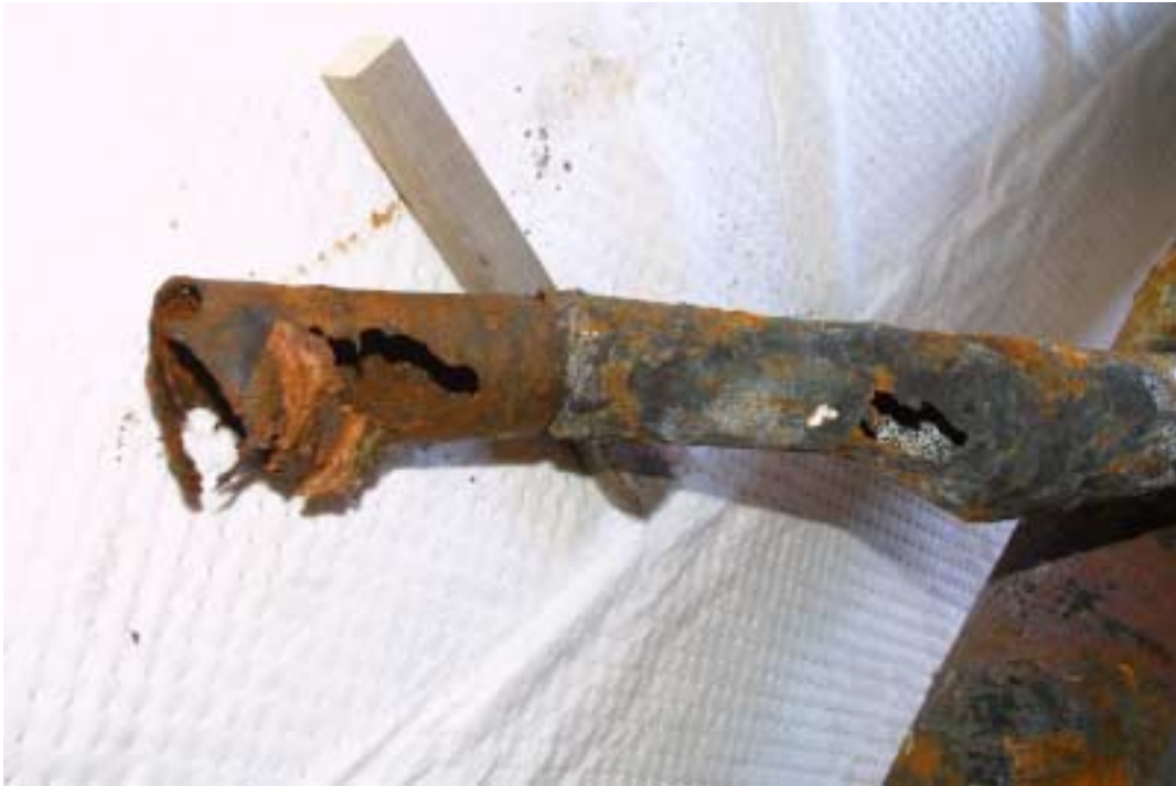
Kuva 8. Lämpökattilan savuhormin syöpynyt alkupää. VTT:lle toimitettu osa on leikattu irti puupalikan kohdalta. Myös leikkauskohdan yläpuolella olevassa mutkassa näkyy reikä. Hormin alla ollut pakoputken osa on poistettu ennen kuvausta.
