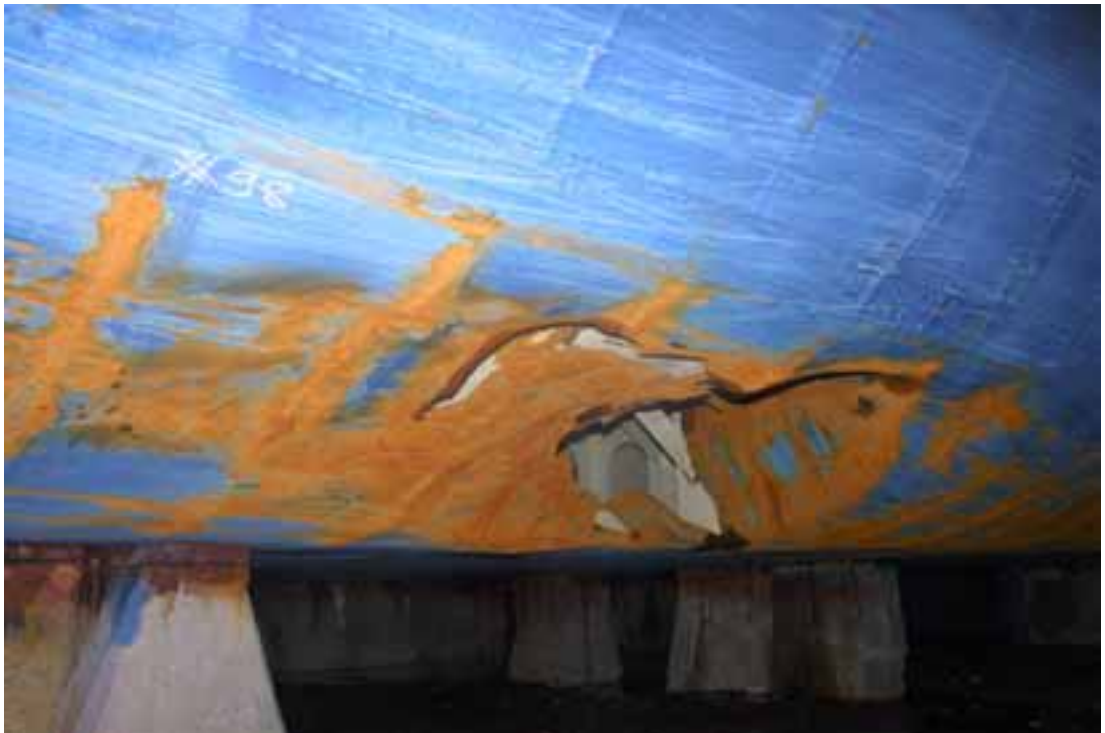
Kuva 19. Keskilaivalle repeytynyt suuri reikä
