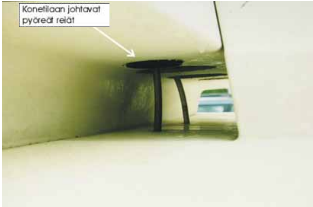
Kuva 4. Konetilan ilmanottoaukot kuvattuna sivukanavaa pitkin
