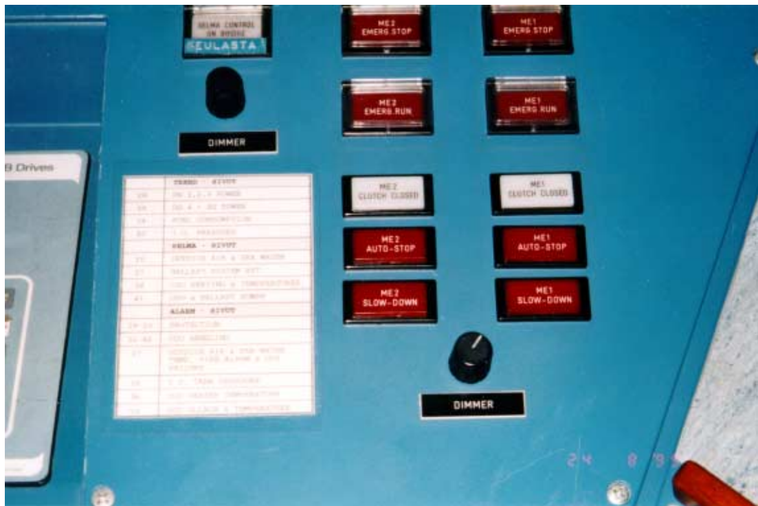
Kuva 9a. Pääkoneiden hätäpysäytykset
