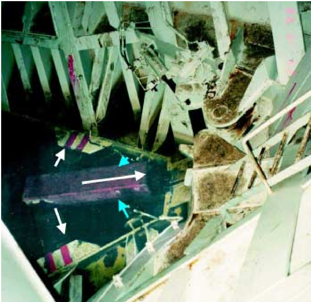
Kuva 4. Vaurioitunut keulaportin alakeskituki Tukholmassa suoritetun alustavan korjauksen jälkeen. Korjauksen yhteydessä oli tehty mm. vahvistus hitsaamalla tuen päälle RHS-palkki tukemaan lommahtanutta tuen pitkittäistä rankaa. Valkoiset nuolet osoittavat keulaporttiin kohdistuvia voimia vastaanottavia tukia ja vaaleansiniset nuolet jäärrötussylinterien kiinnityskohtia.
