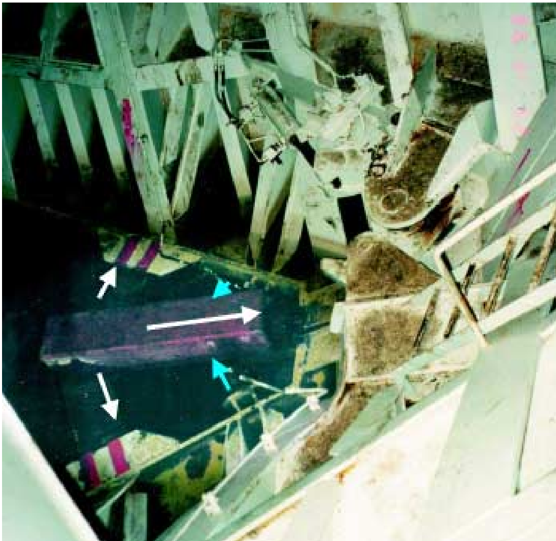
Figur 4. Bogportens skadade nedre centerklack efter reparation och förstärkning i Stockholm. Förstärkningen hade utförts genom att svetsa längsgående en s.k. RHS balk på centerklacken som stöd för den bucklade stommen. De vita pilarna visar stödkrafter åt portarna och de ljusblå pilarna isbräckarcylindrarnas fästen.
