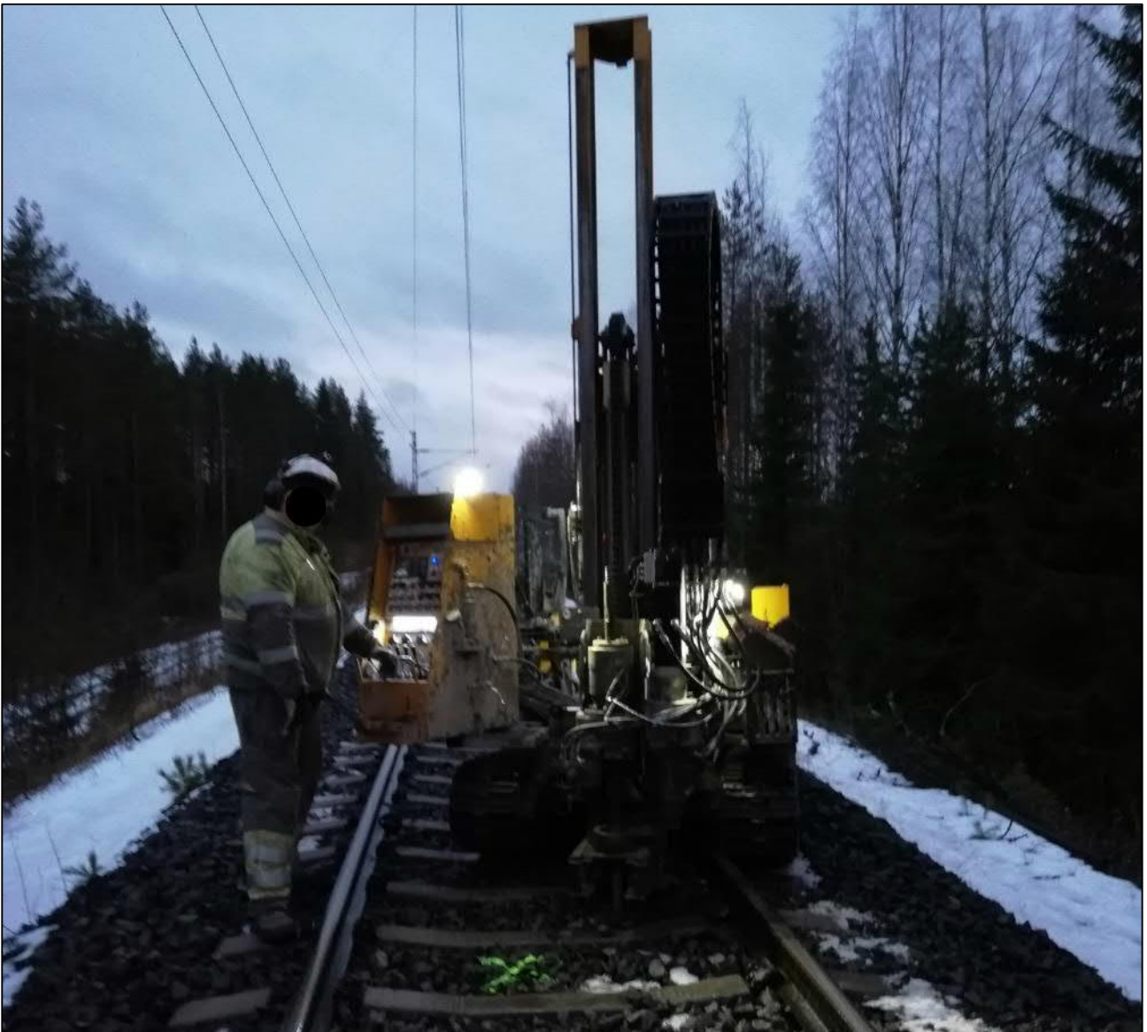
Kuva 9. Kairakoneenkuljettaja työssänsä tapahtumapaikalla vähän ennen onnettomuutta. Koneen kaira on pystyssä maanäytteen ottoa varten. Hämärä oli laskeutumassa vaikeuttaen kairakoneen havaitsemista raiteella. Koneen etupuolella oleva vilkkuvalo ei näy junan tulosuuntaan. (Kuva: Golder Oy)
