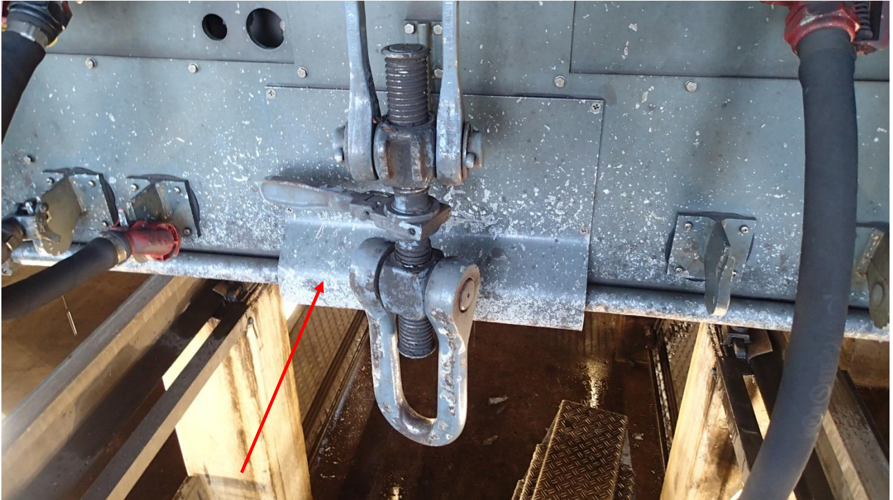
Kuva 2. Kuva vaunusta, jossa suojalevy on paikoillaan. Levy on kooltaan 500 x 376 mm. Se on 8 mm teräslevyä ja painaa 14,2 kg. Ruuvikytkin roikkuu kuvassa vapaana. (Kuva: OTKES)
