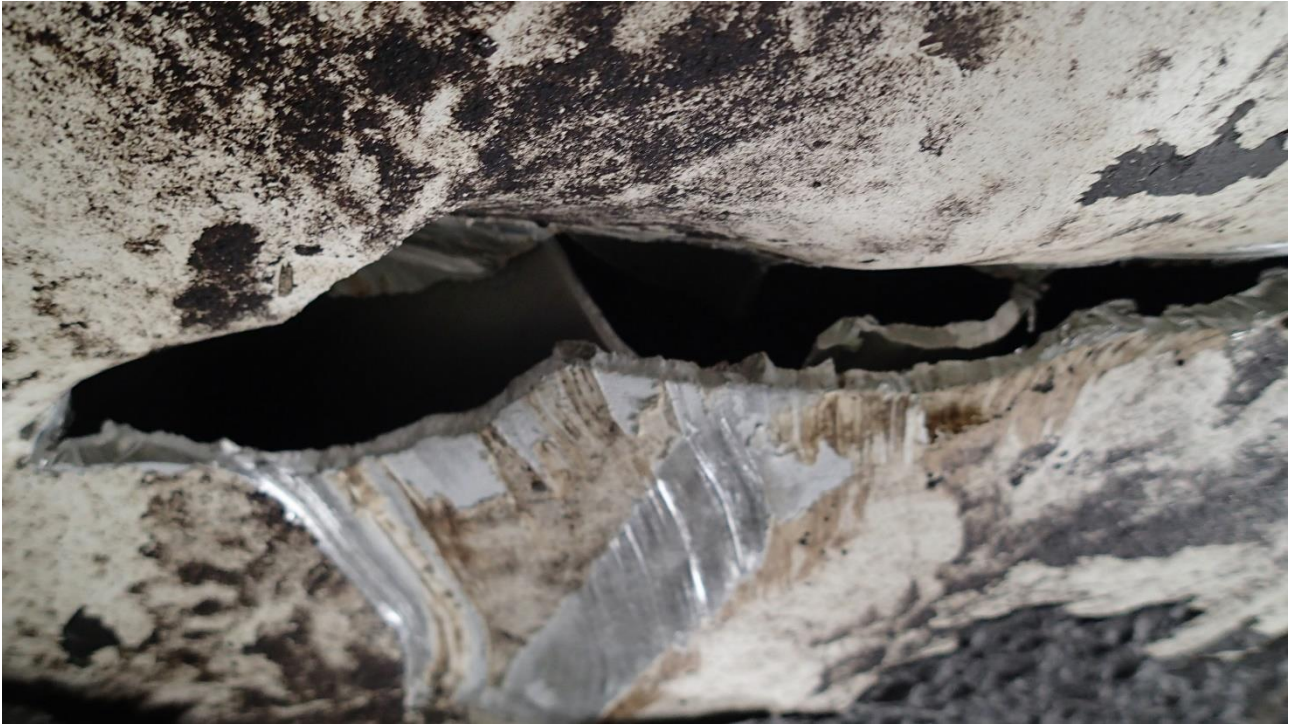
Kuva 4. Lähikuva yhdestä vaunun Ed 28007 pohjalevyn pahimmista vaurioista. (Kuva: OTKES)
