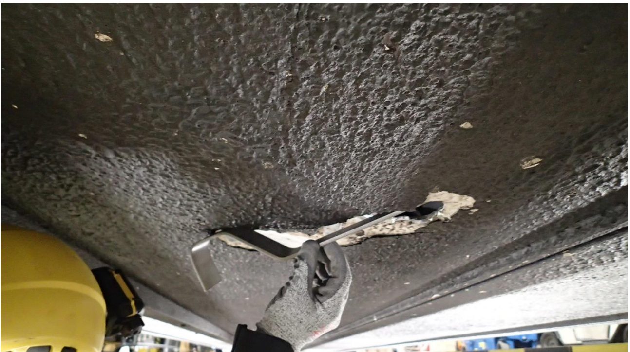
Kuva 9. Vaunun pohjan vaurioiden vertailu suojalevyn mallineella. (Kuva: OTKES)
