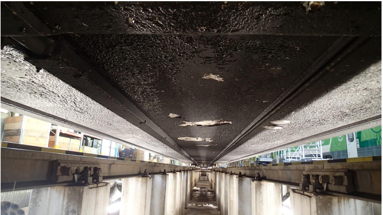
Kuva 3. Yleiskuva vaunun Ed 28007 pohjan vaurioista (Kuva: OTKES)
