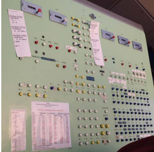
Kuva 6. Vainikkalan liikenteenohjauksen ohjaustaulu.
