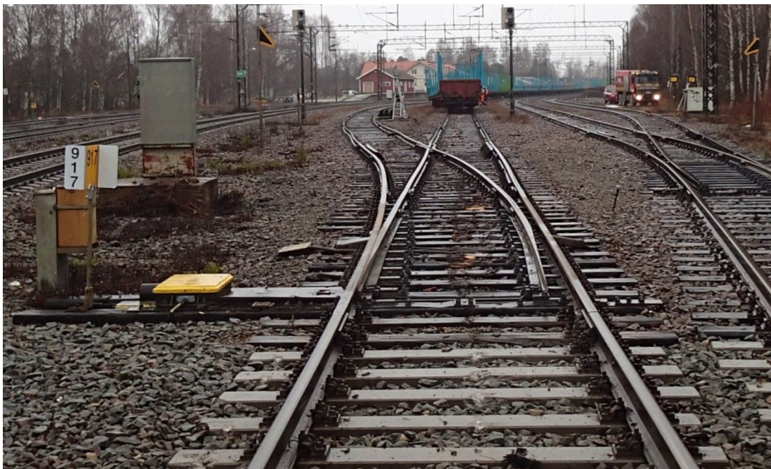
Kuva 2. Tavarajuna on raiteella 904 osittain suistuneena. Suistuneiden vaunujen kaatama opastinmasto E904 näkyy kallellaan viimeisen vaunun vasemmalla puolella. Ratapölkkyissä, vaihteessa V917 ja vaihteesta vasemmalla johtavan raitteen 903 kiskoissa näkyy vaurioita.
