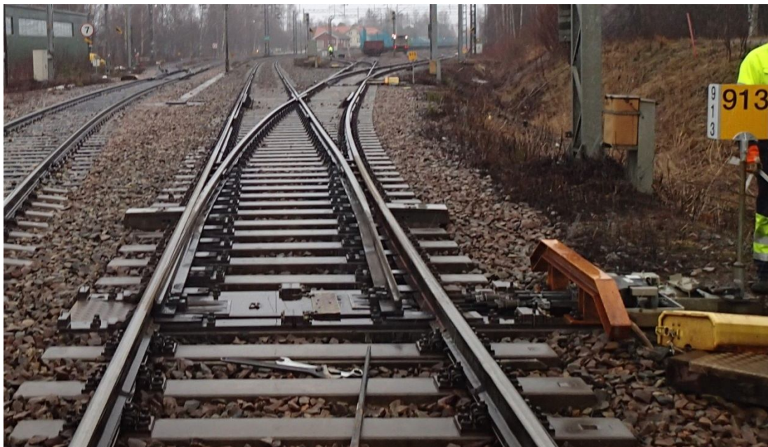
Kuva 3. Suistuminen alkoi oikealla kääntyvässä vaihteessa V913. Tämän jälkeen junan kulkutiellä oli vielä vaihteet V915 ja V917 ennen raidetta 904.
