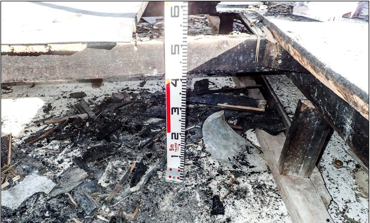
Kuva 19. Vesikattona oli betonisen yläpohjan päälle palavasta materiaalista rakennettu ontelon rakenne. Vesieristeenä oli kermi. (Kuva: OTKES.)
