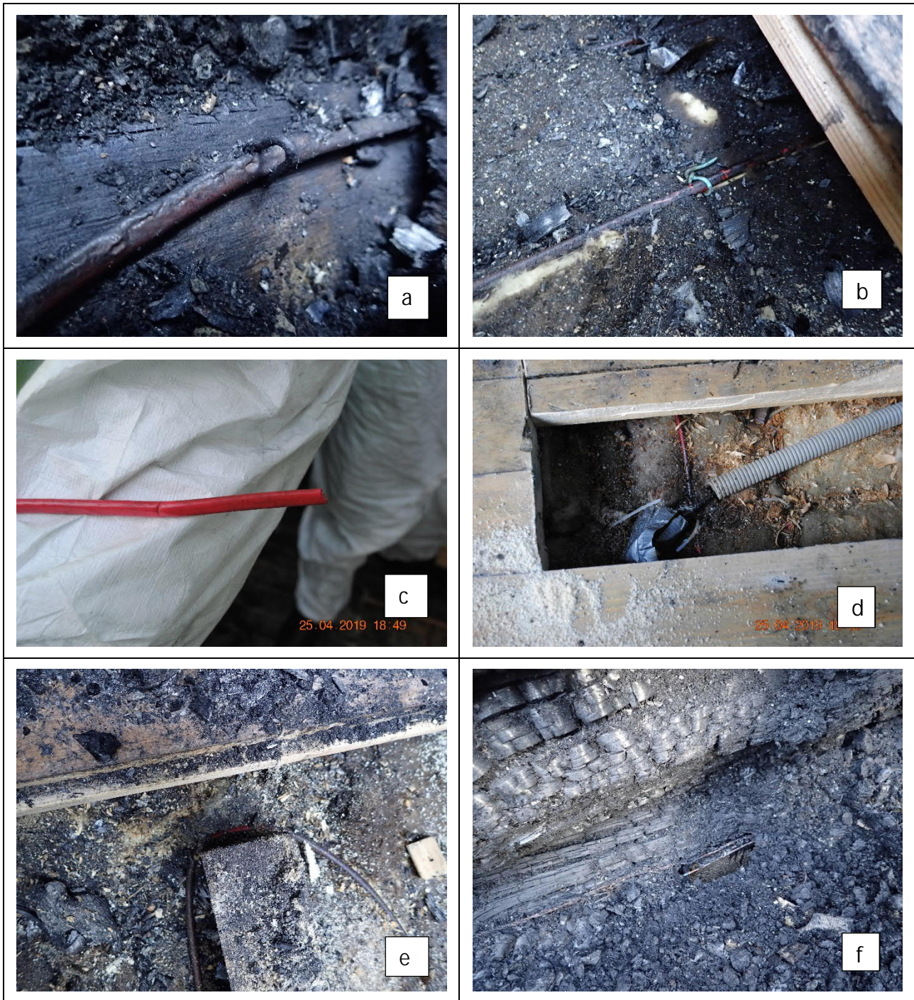
Kuva 6. Kuvia lattialämmityskaapelin asennuksen ongelmista: a) kaapelia oli kiinnitetty kaapelia puristavilla metallihakasilla b) kaapeli oli osittain upoksissa eristevillassa, c) nippusiteitä oli käytetty kaapelia puristavalla tavalla, d) termostaatin anturi oli lähes kiinni kaapelissa, e) kaapeli oli paikoin taivutettu tiukalle mutkalle ja kosketuksessa puuhun, f) kaapelia oli kiinnitetty hirsiseinään. (Kuvat: OTKES)
