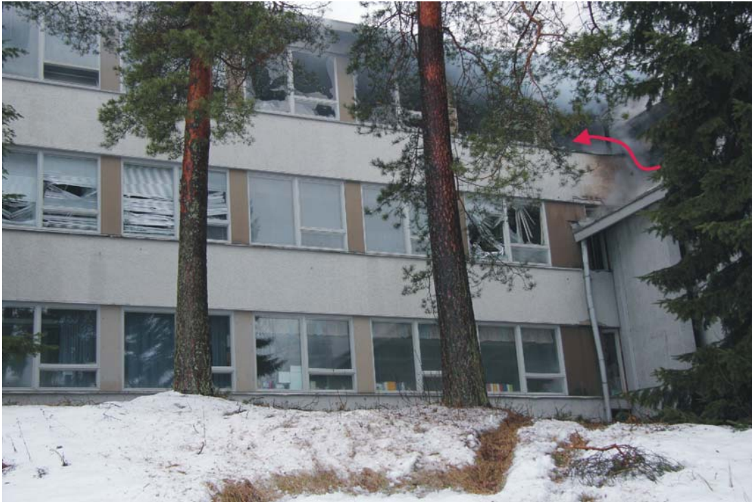
Kuva 18. Tulipalo levisi ylimmässä kerroksessa olleeseen opettajainhuoneeseen ulkokautta nurkkauksessa olleen ikkunan rikkouduttua (punainen nuoli). (Kuva: poliisi)
