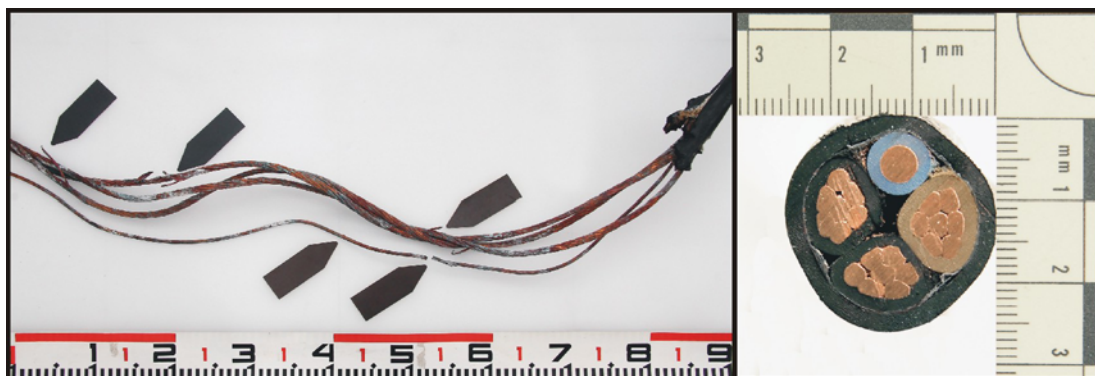
Kuva 11. Palojälkien ja valokaarijälkien perusteella palo syttyi nelijohtimisessa kaapelissa, jossa oli merkintä NOKIA 4 55 1983 0841 MMK 3x35 +16 N1KV. Kaapeli tuli alemmassa kerroksessa olleesta syöttöpääkeskuksesta. (Kuvat: poliisi)
