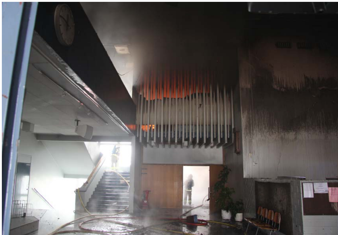
Kuva 4. Kuva koulun pääovelta sammutustöiden aikaan. Ylhäällä keskellä urkuparvi, jonka kautta savu ja tuli levisivät liikuntasalista koulun aulatilaan. (Kuva: poliisi)
