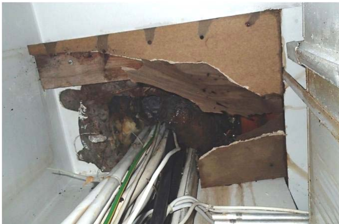
Kuva 20. Syttymiskohdan kaapelinippu kuvattuna kerrosta alemmaa alhaalta ylöspäin. Kaapelikourussa kulkee runsaasti kaapeleita, ja niitä on kiinnitetty toisiinsa muun muassa nippusiteillä. Palon syttymiskohta jää kerrosten väliin. (Kuva: Otkes)
